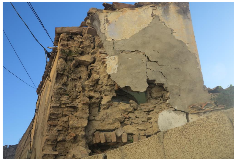
Figure 37 mur effondré partiellement
