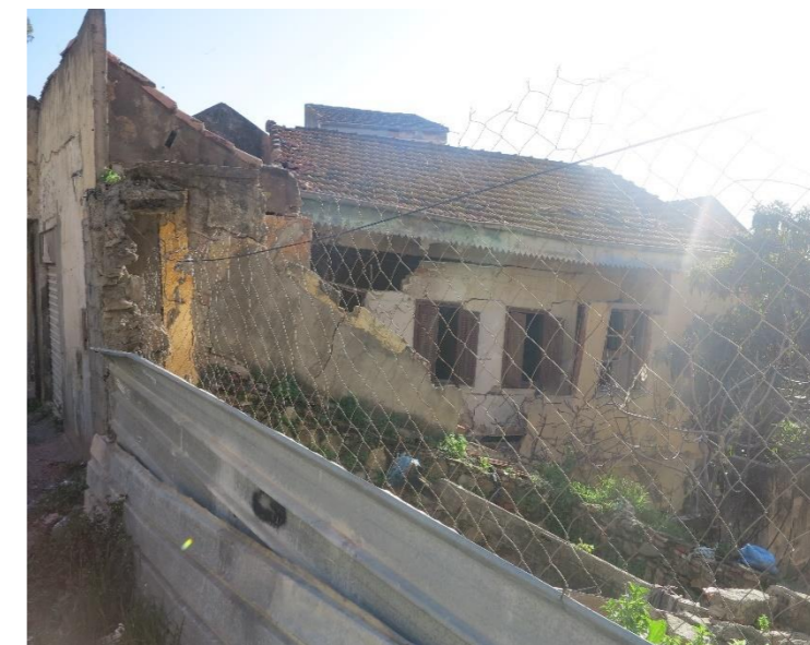
Figure 38 la maison de bab el louz dégradée
