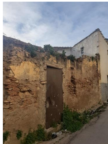
Figure 39 façade dégradée de la maison de bab el louz
