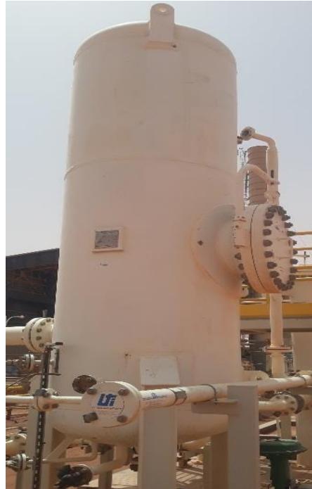
Figure II.4 : Ballon séparateur V101 (photo prise sur site)
