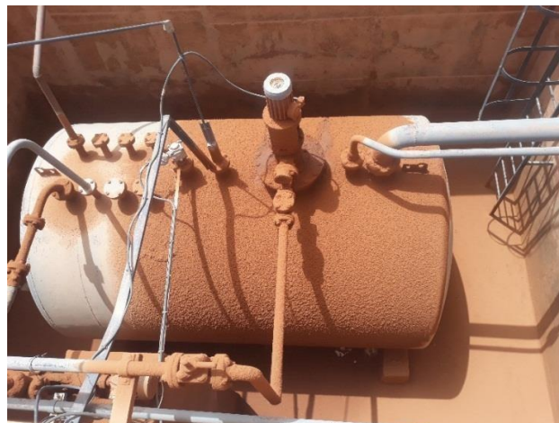
Figure II.7 : Bâche à déchet condensat (photo prise sur site)
