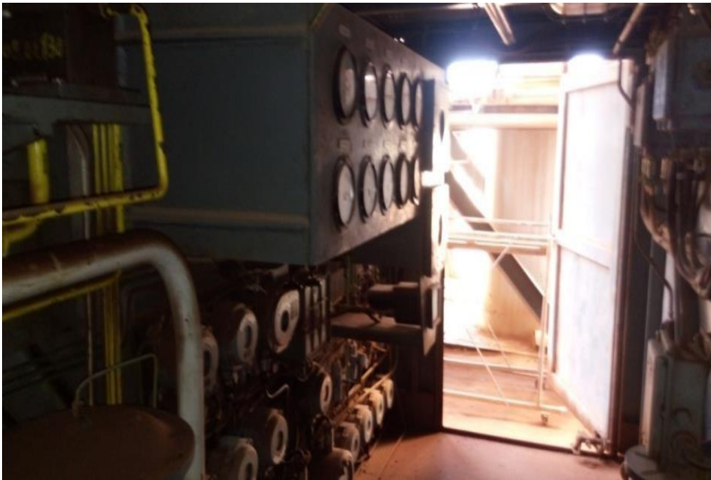
Figure I.13 : La cabine de régulation SFAC
