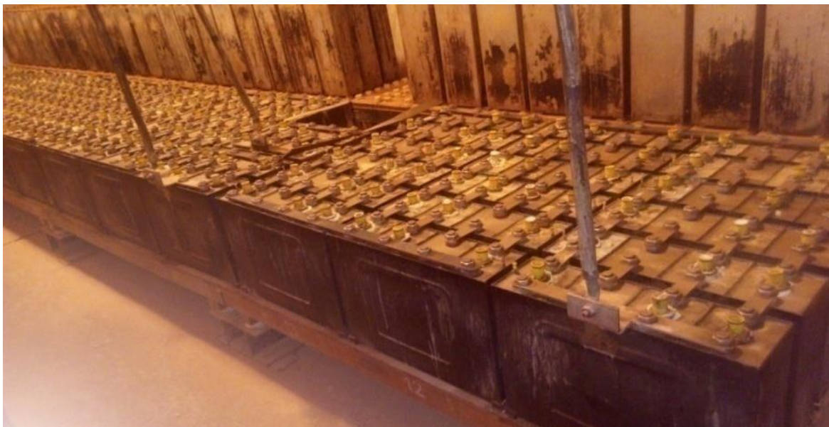
Figure I.09 : Local des batteries
