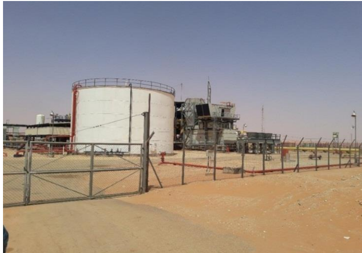
Figure II.8 : Bac de stockage TK-104 (photo prise sur site)
