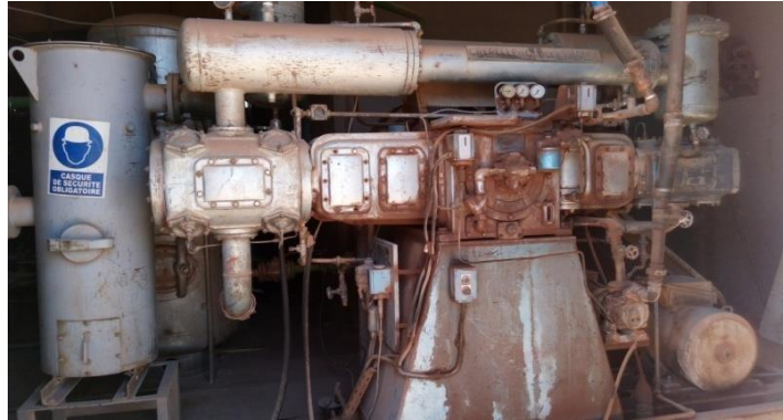
Figure I.06 : Compresseur à piston CREPELLE
