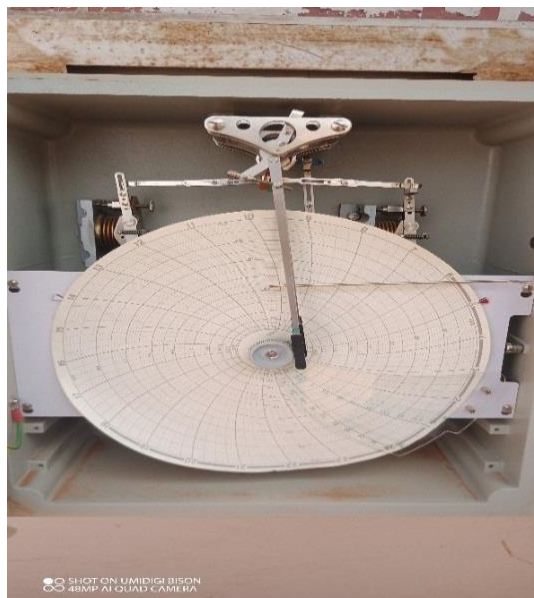
Figure II.14 : Enregistreur (photo prise sur site)
