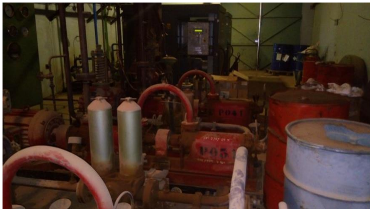
Figure I.07 : Salle des pompes
