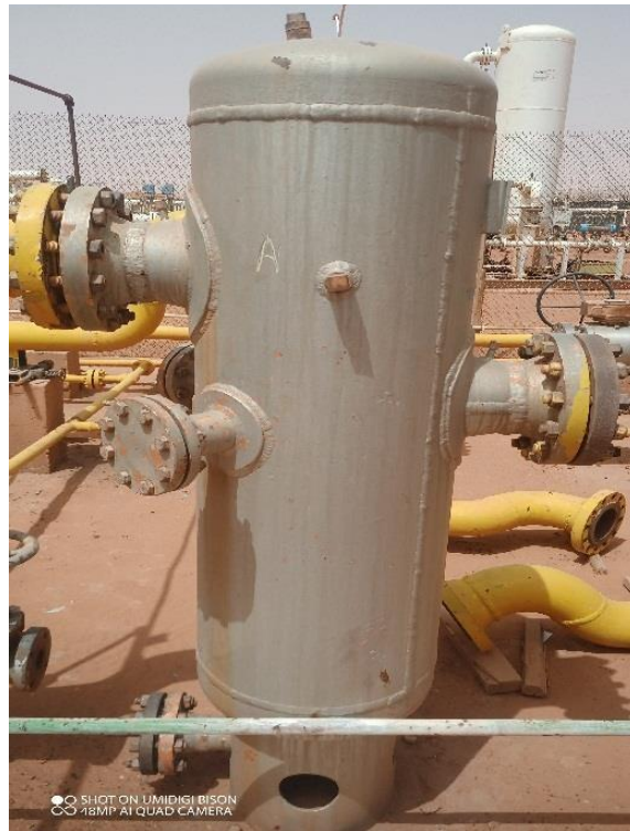
Figure II.5 : Ballon filtre BF102A (photo prise sur site)
