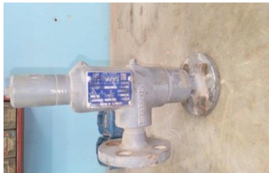
Figure II.10 : Soupape de sécurité (photo prise sur site)
