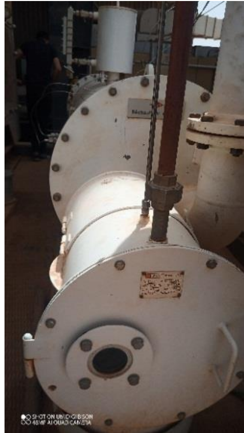
Figure II.6 : Réchauffeur à gaz (photo prise sur site)
