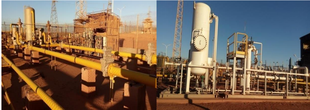
Figure I.11 : Postes à gaz (ancien et nouveau)
