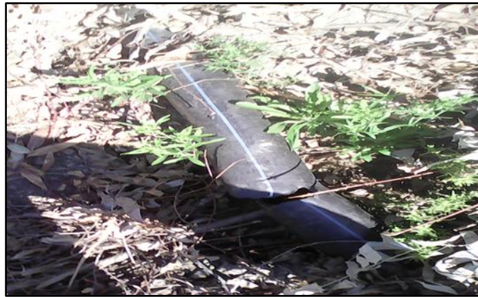
Figure (I.5) : dégradation de la conduite de refoulement
