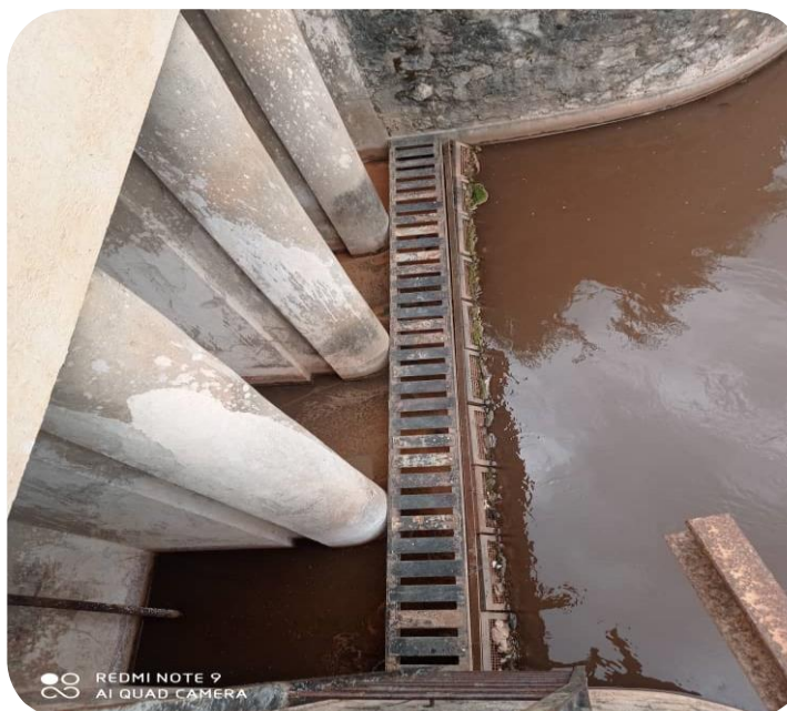
Figure (III.6) : Système de Dégrillage
