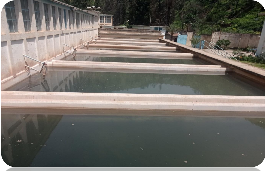
Figure (III.15) : Filtres à sable fin
