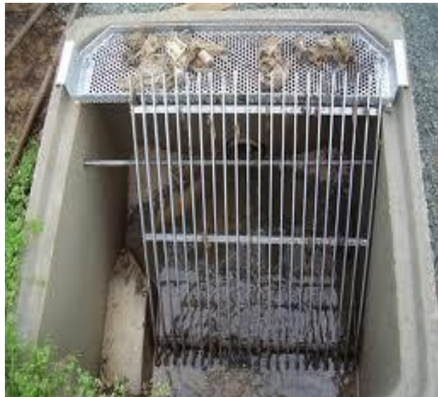
Figure (II.2) : Système de dégrillage
