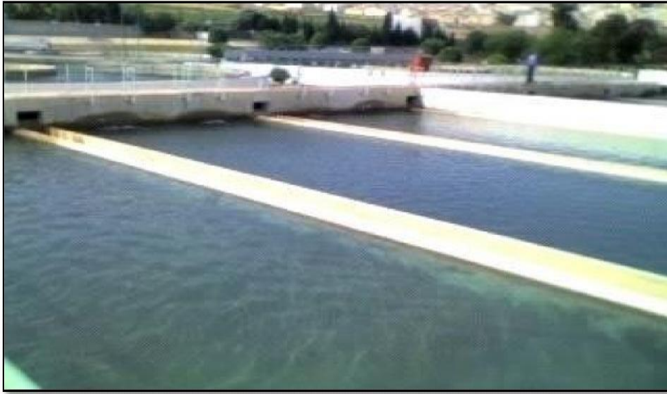
Figure (II.6) : Filtres à sable (
