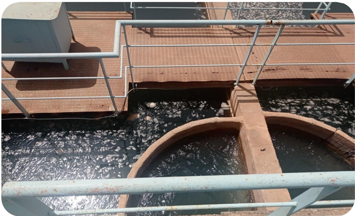
Figure (III.13) : Bassin de floculation
