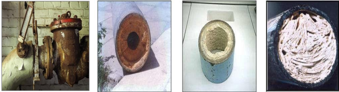
Figure A.I.1: L'entartrage des tuyaux PVC [5].
