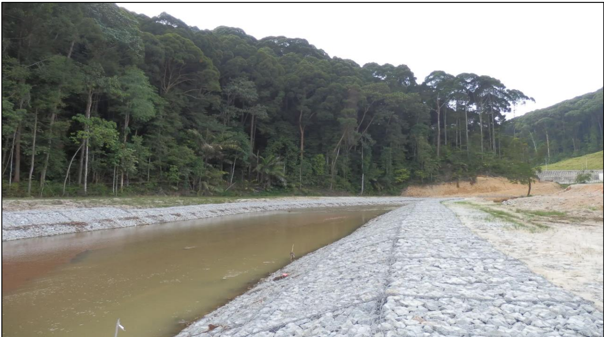
Figure (IV.3) : Canal en matelas Reno (Image tirée du web).
