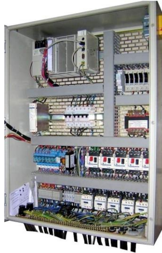
Figure II-9 : Composants électriques d'une armoire
