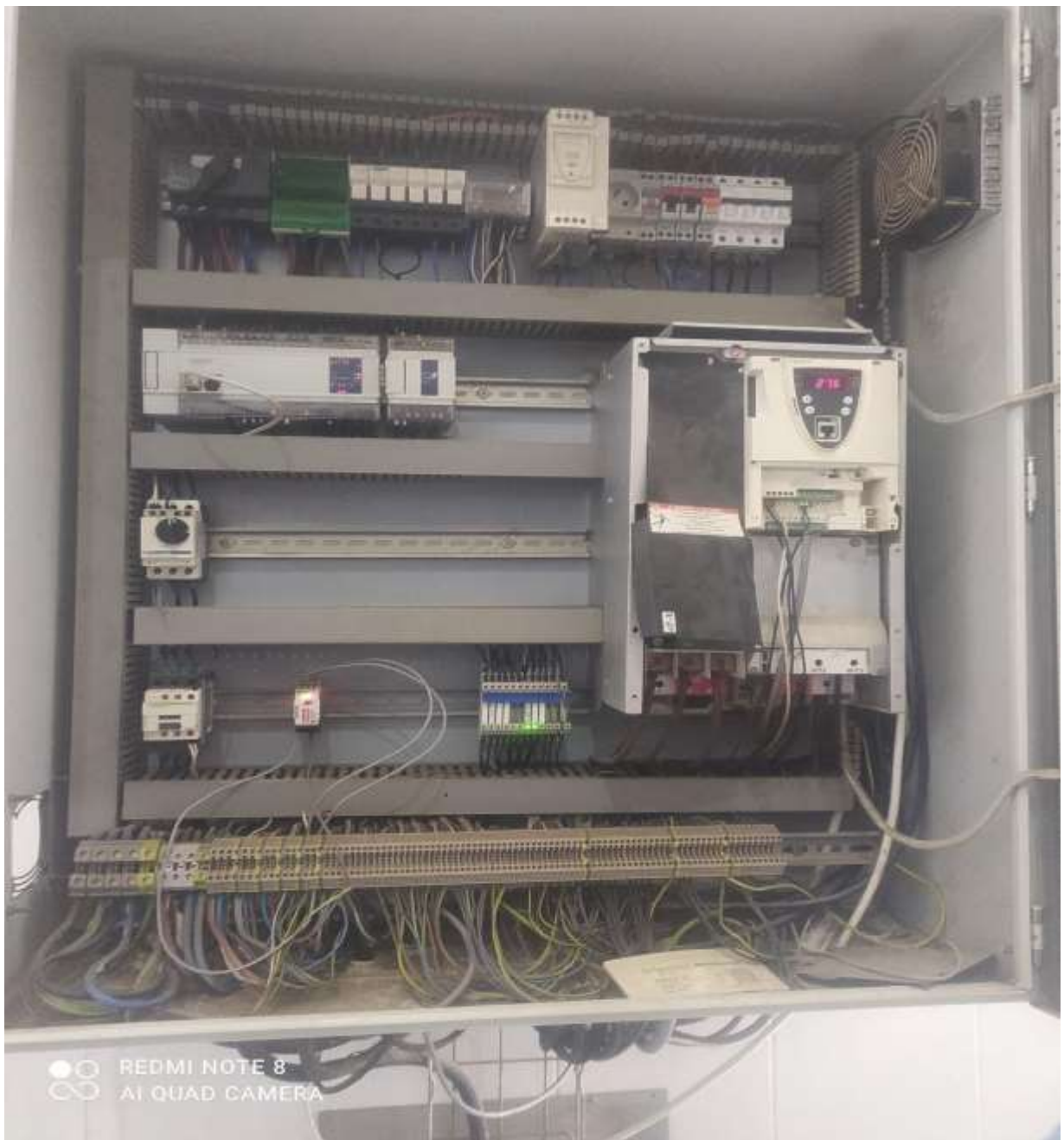
Figure V.2 : Vue de l'armoire électrique
