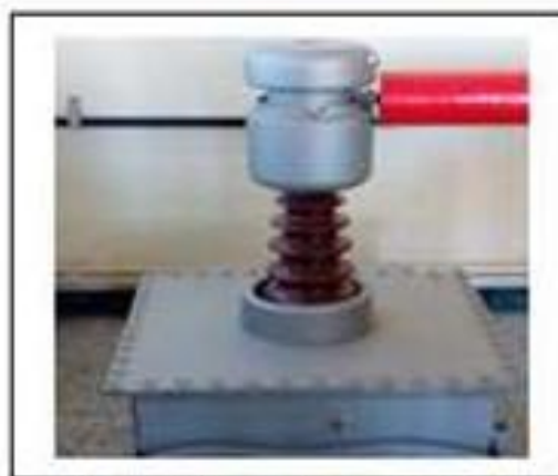
a) Transformateur haute tension T100 ;
