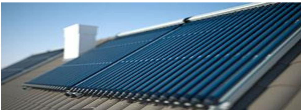
Figure I.5 : Panneaux solaires thermiques
