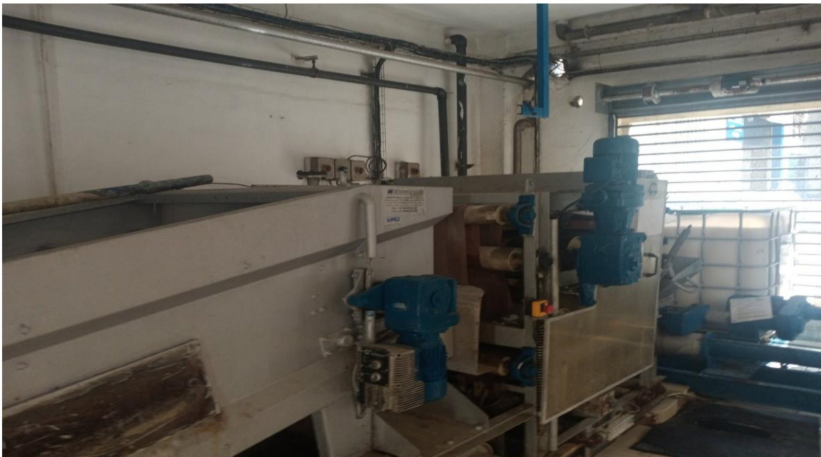
Fig 12 : Système de traitement des boues (cliché Zidani, année inconnue)
