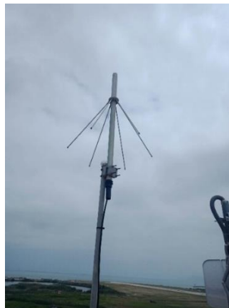
Figure 3-16 : L'antenne Ground plane VHF avec 6 radians
