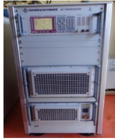
Figure 2-39 : Baie radio HF
