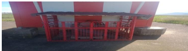
Figure 2-19 : Transformateur abaisseur de la station VOR/DME
