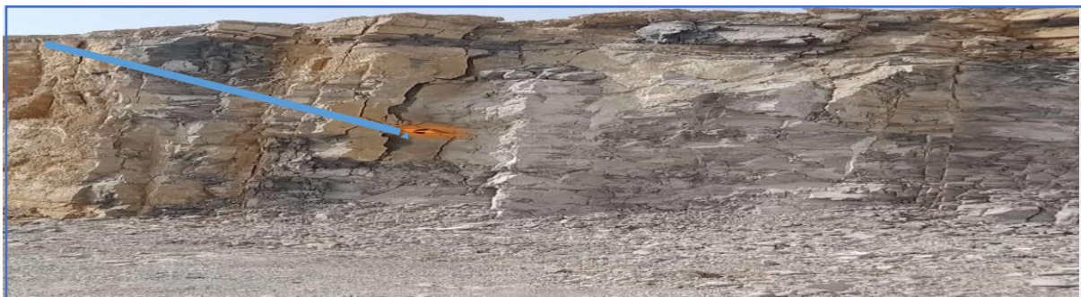
Figure II.10. La fissuration du massif rocheux. [2]
