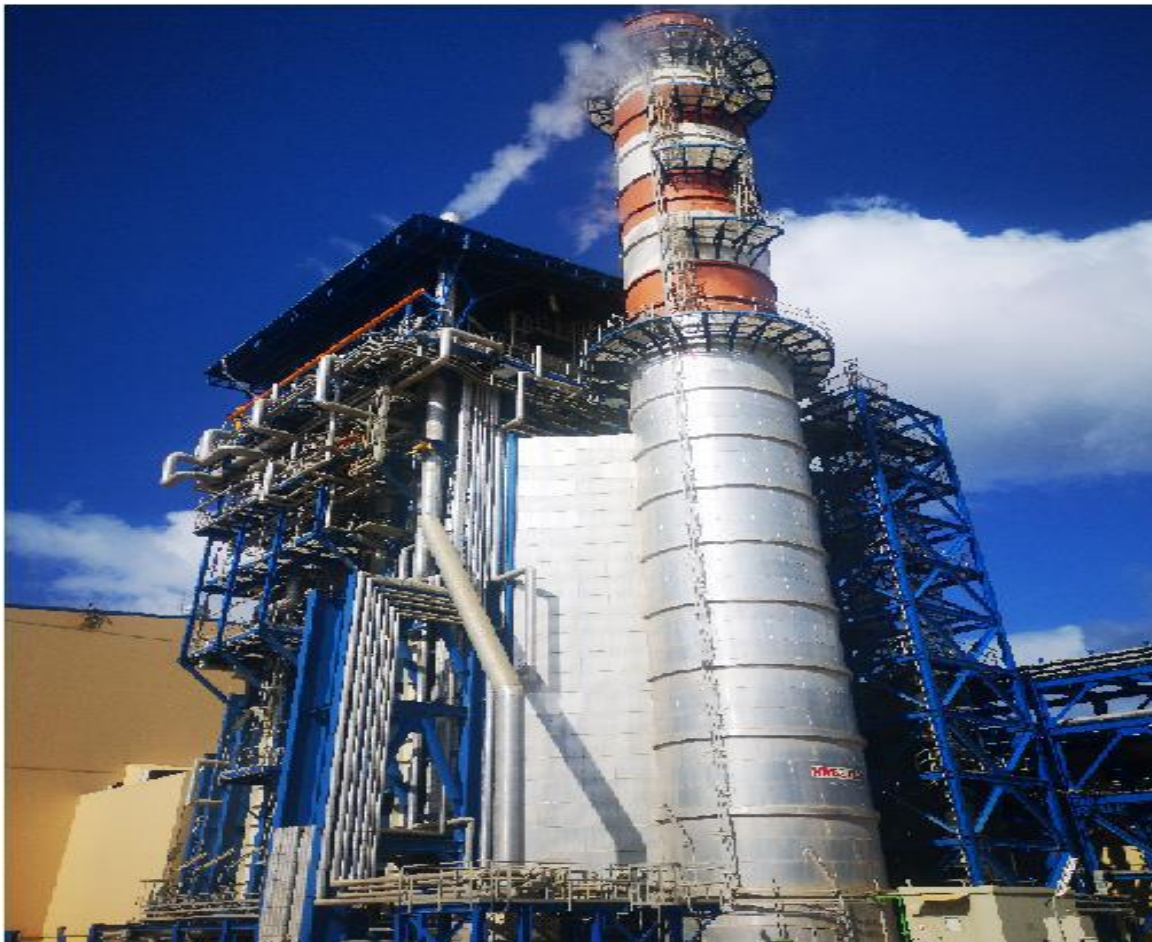
Figure I.3 : Vue globale de la chaudière de récupération
