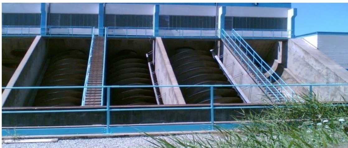
Figure III. 15 . Poste de relèvement.de la STEP Baraki.
