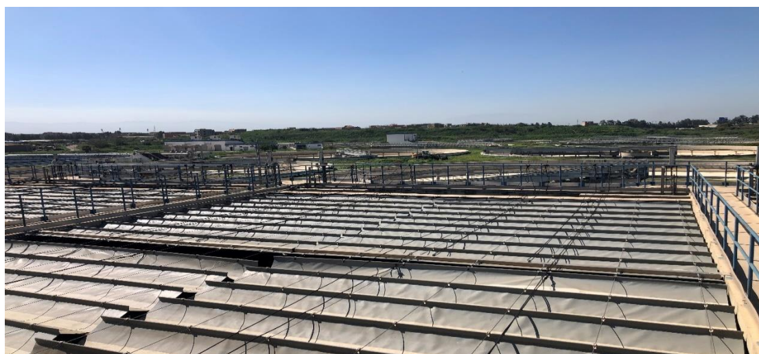
Figure III.22 . Lit de sable, filtration par filtres Aquasures
