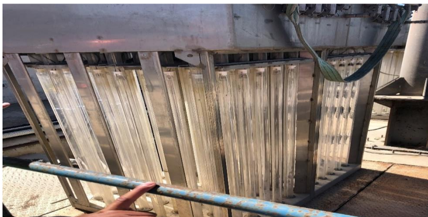
Figure III.23. Désinfection par les lampes UV STEP Baraki
