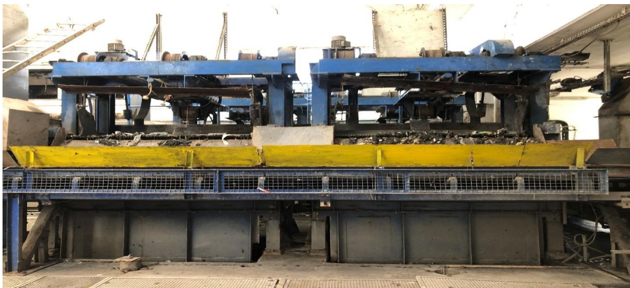
Figure III. 16. Dégrilleur mécanique fin et grossier de la STEP Baraki
