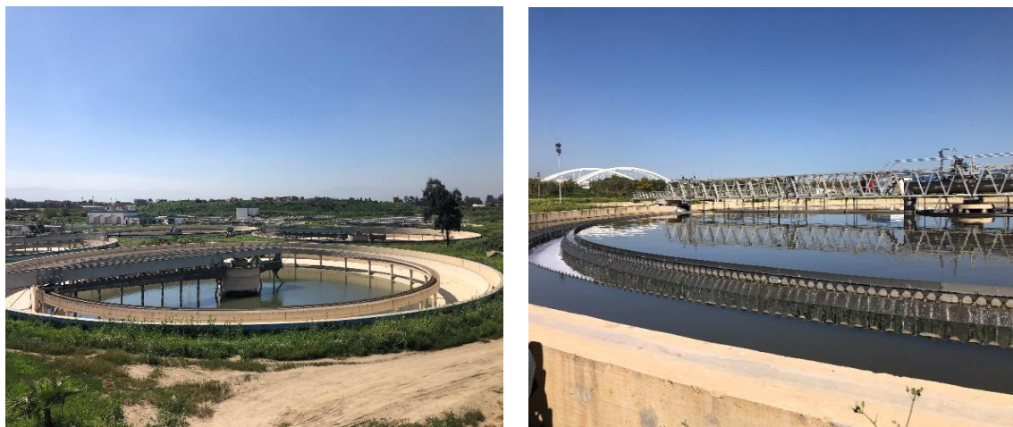
Figure III. 21. Clarificateur de la STEP Baraki,
