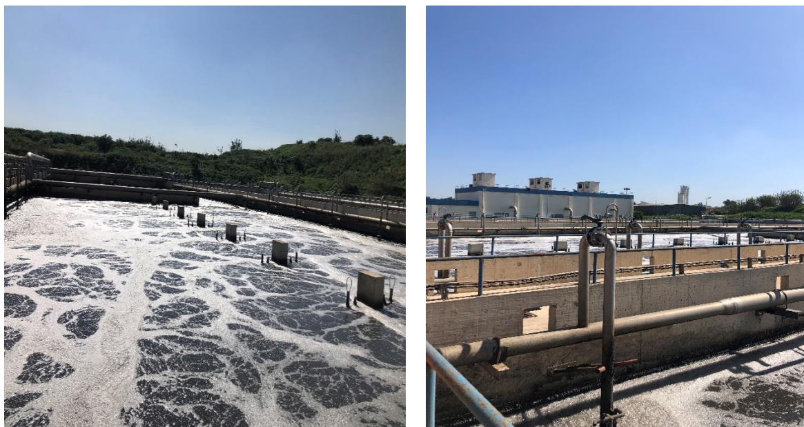
Figure III.20 . Bassin d'aération de la STEP Baraki (2023)
