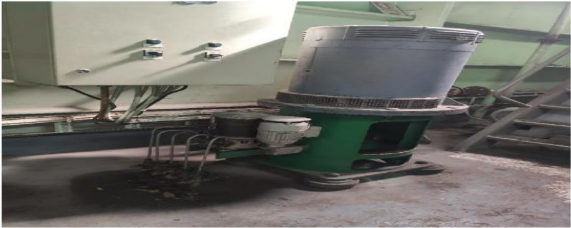
Figure II.2 : Pompe centrifuge pour le ballastage.
