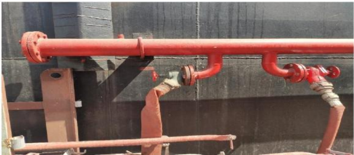
Figure II.4 : Tuyauterie en acier (HP).
