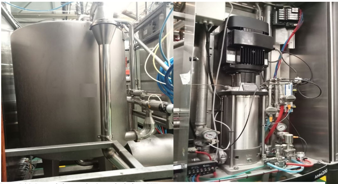
Figure I-16: Image de la cuve de réserve huile finie (HF).
