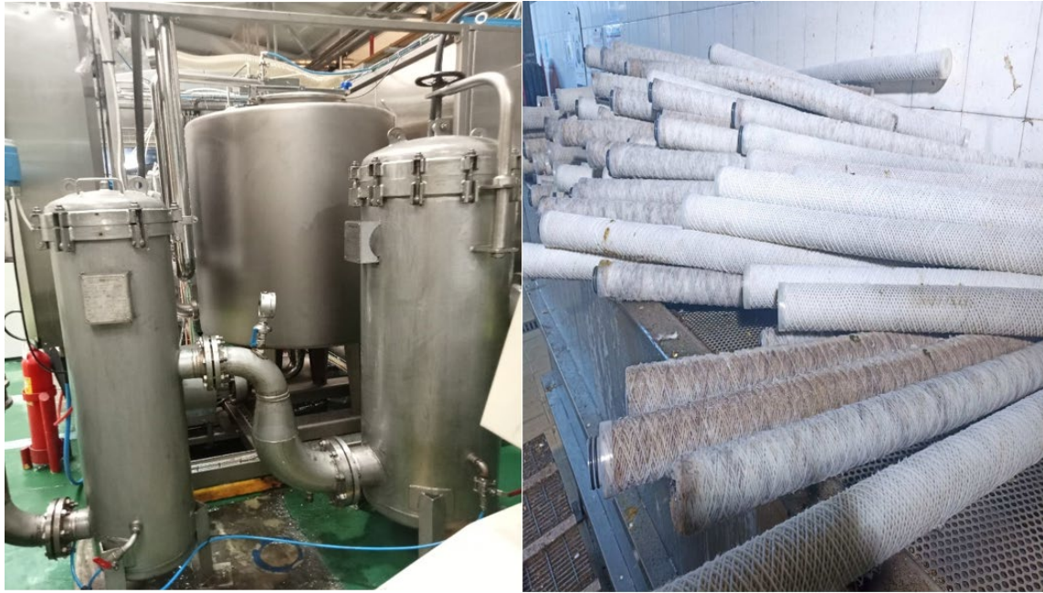
Figure I-13: Images des cuves à filtre.
