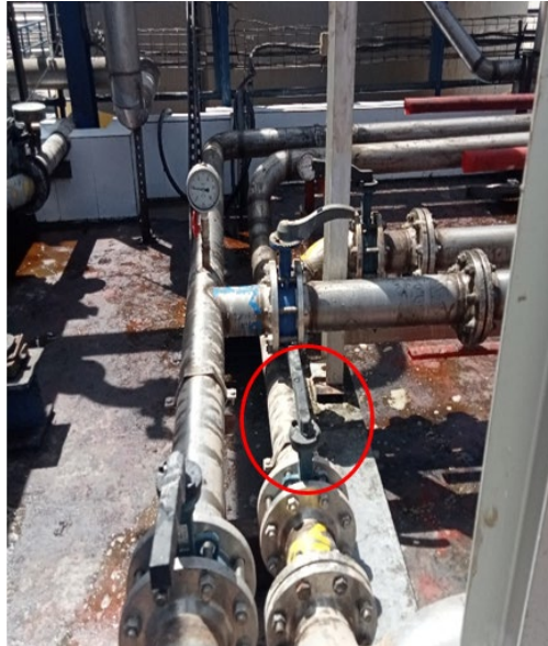
Figure I-12: Image d'une vanne d'échangeur.
