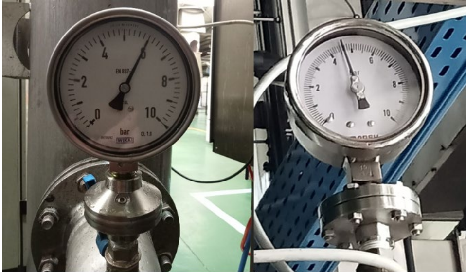
Figure I-14: Images de manomètres qui détectent la pression au niveau des cuves.
