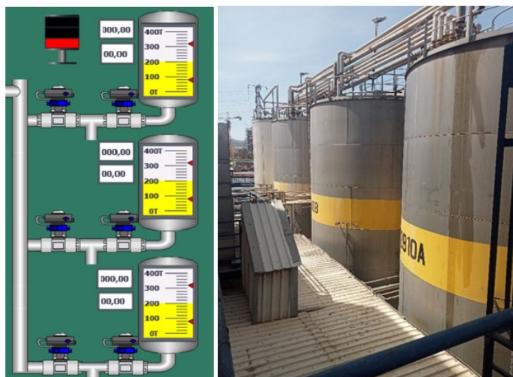
Figure I-3: Les bacs de l'unité conditionnement d'huile Ceval.
