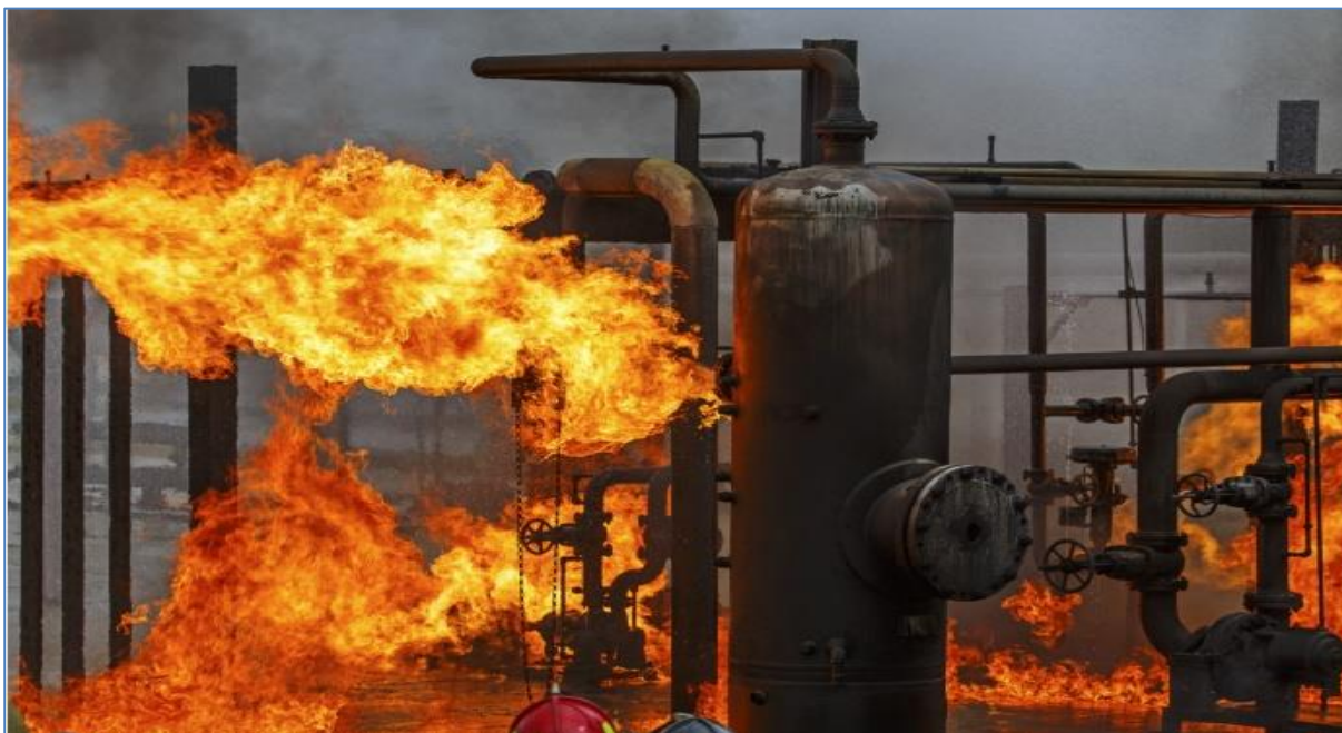
Figure 1.9 : Un incendie à la raffinerie du sud de Philadelphie le vendredi 21 janvier 2019, dû à une négligence à une légère fuite dans l'une des canalisations de transport d'hydrogène [22].
