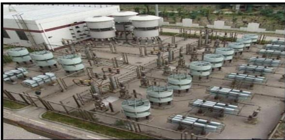
Figure I.4- Compensateurs statiques de la puissance réactive
