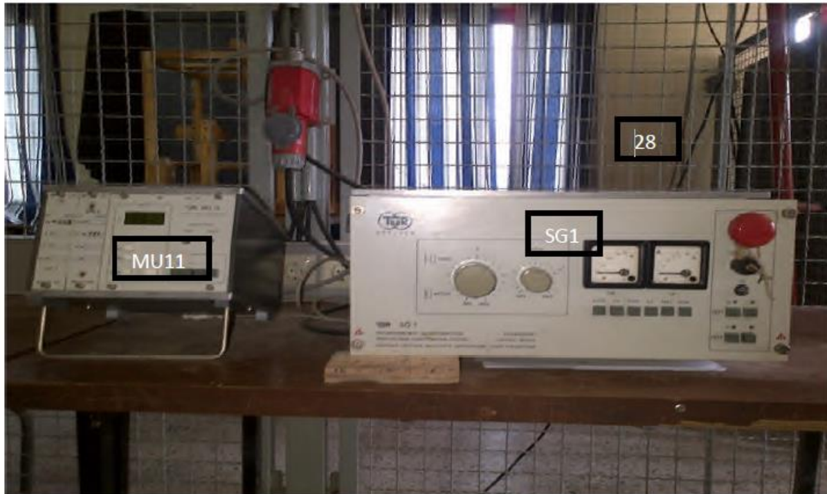
Figure II.3 Equipements de l'installation haute tension utilisée.
