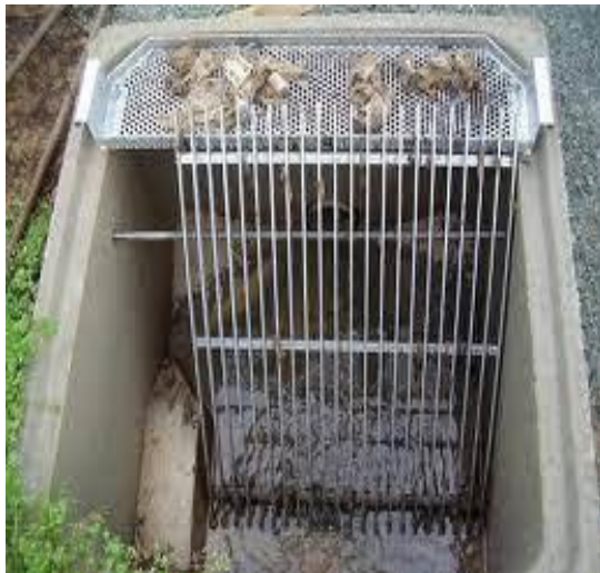
Figure I.4: Dégrilleur primaire grossier.
