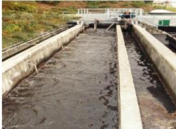
Figure I.6 : Bac de dessablage.
