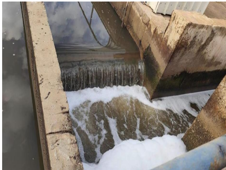
Figure II.9 : Canal de l'eau usée épurée.
