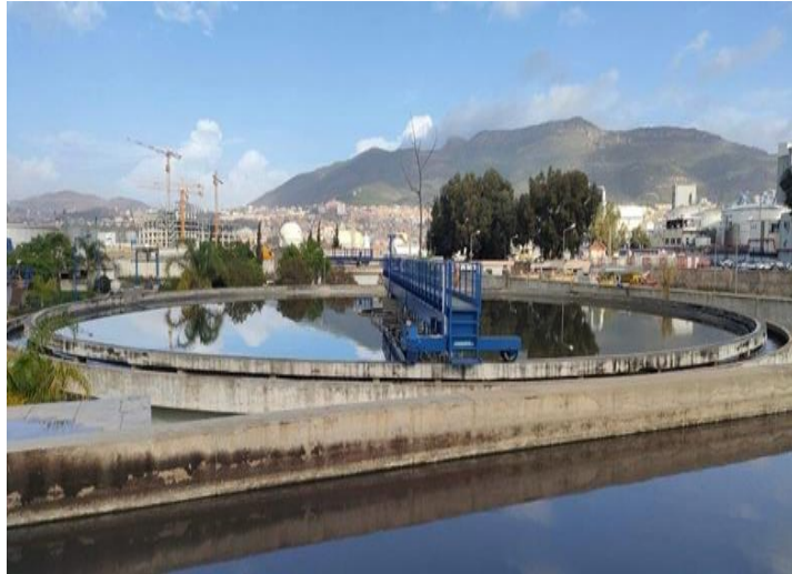
Figure II.8 : Clarificateur (Décanteur secondaire).
