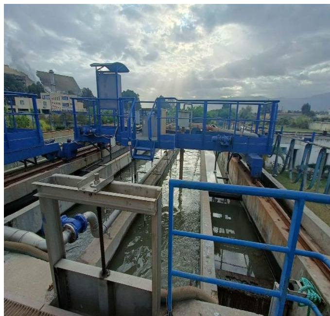
Figure II.5 : Bassin de dessablage (Décanteur primaire).
