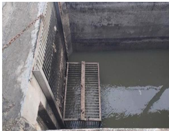
Figure II.3 : Dégrilleur primaire grossier.
