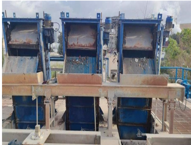
Figure II.4 : Dégrilleur secondaire fin
