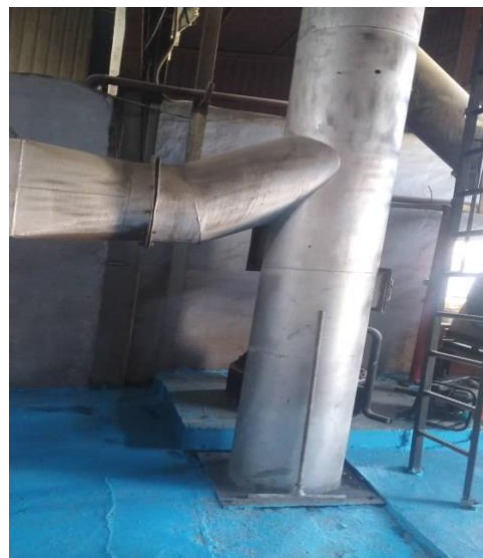
Figure 2.19 : Cheminée d'évacuation de fumée traité
