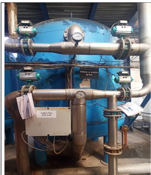
Figure II.5 : photographie d'un filtre à sable au Niveau de cevital
