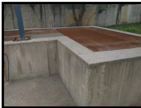
Figure 10 : canal d'arrivée d'eaux usées
