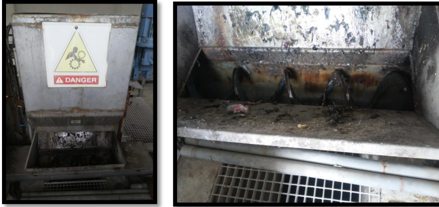
Figure 11 : le dégrilleur fin
