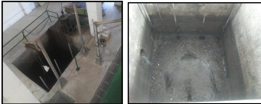
Figure 10 : le dégrilleur grossier
