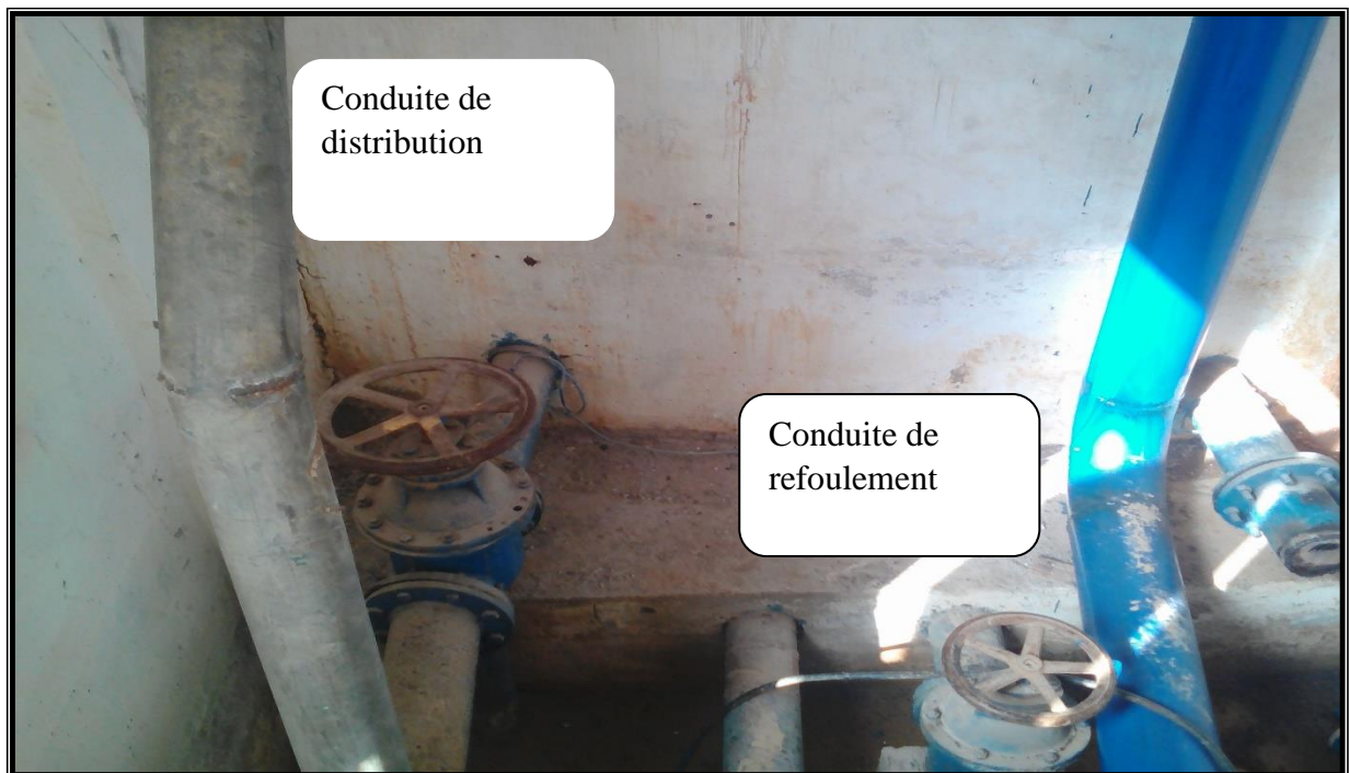
Figure (1.6) : Chambre de vanne du réservoir 300 m 3 existant d'Azaghar
