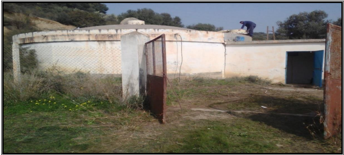
Figure (1.4) : Réservoir 300m 3 existant qui alimente la localité Azaghar
