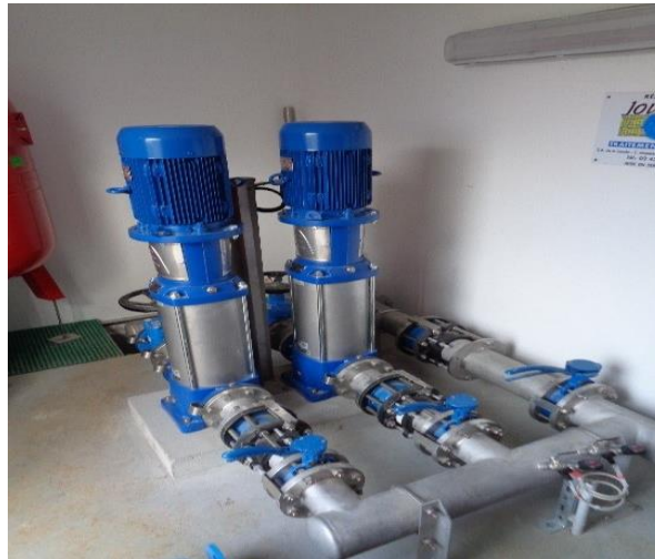
Figure V.3 : Installation d'une pompe verticale
