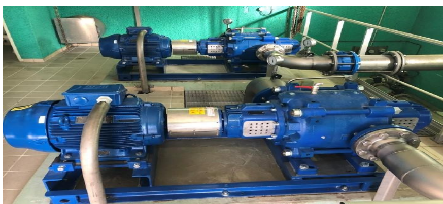
Figure V.2 : Installation d'une pompe horizontale
