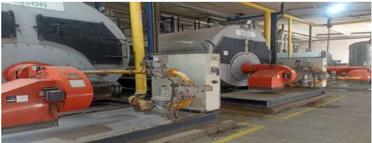
Figure II.2: Les trois générateurs de vapeur CEVITAL
