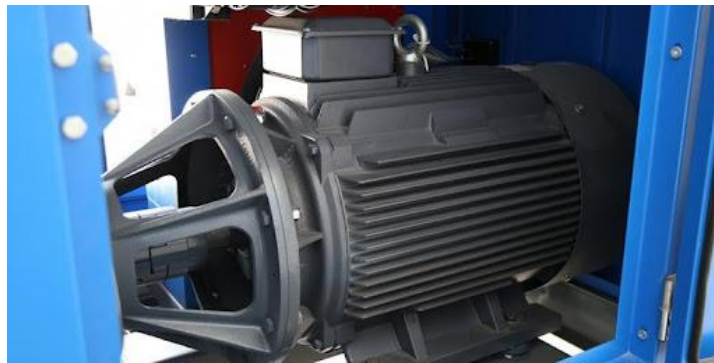
Figure III-10 : moteur électrique d'un compresseur à vis.
