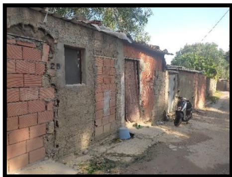
Figure 15: Dégradation d'une façade principale d'une habitation.(source:auteur,2024).
