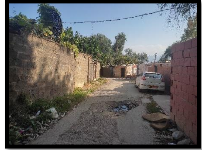
Figure 11: Dégradation de la voirie dans la cité Soummari. Source: auteur, 2024).
