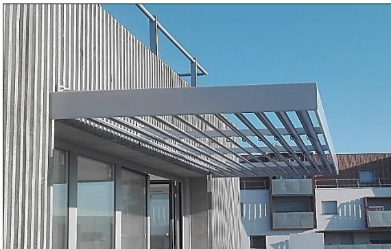
Figure 24: brise soleil verticale en aluminium avec des lames fixes (Source : https://www.duco.eu )
