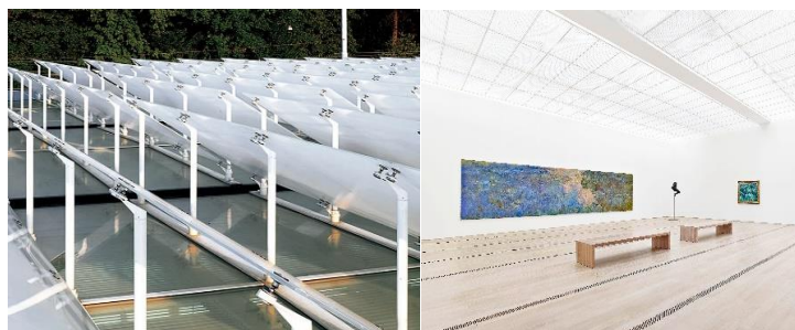
Figure 43 : verrière plate avec une protection solaire extérieure par des panneaux de verre émaillés et inclinés (Source : https://arquitecturaviva.com , 2024)
