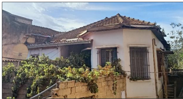
FIGURE 177: ETAT ACTUEL DE LA MAISON AGRICOLE
