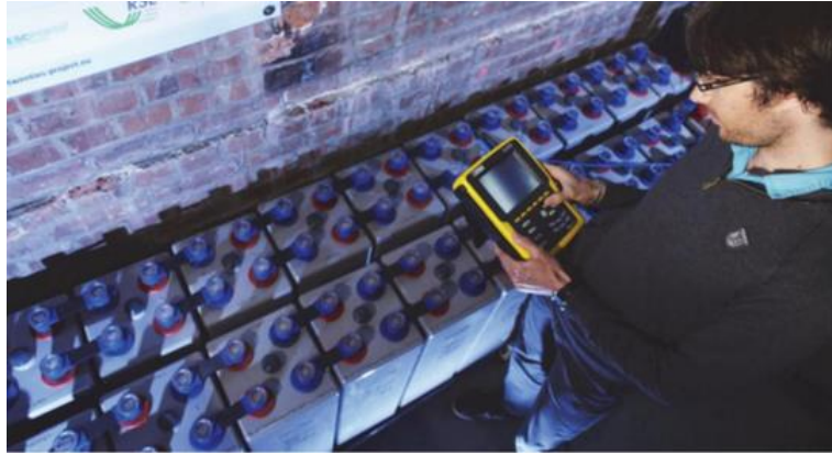
Figure II.10 : Batteries au plomb Energysys : 24 unité, tension nominale de 48V, courant nominal de 200A, puissance de 10kW, capacité de 1000Ah (L2EP AMPT Lille).
