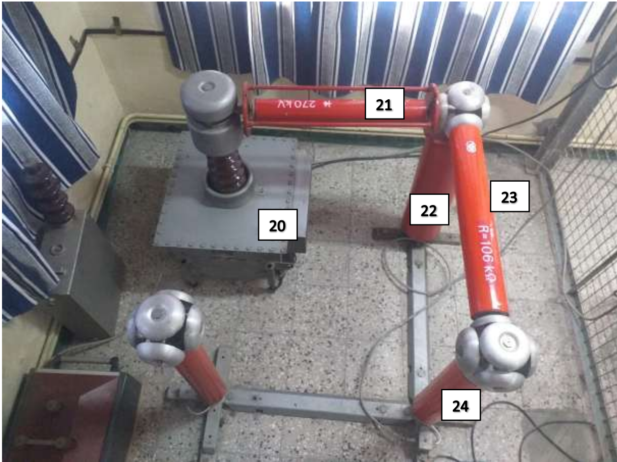
20 : Transformateur haute tension (T100) 21 : Diode haute tension (G270). 22 : Condensateur de lissage (C10). 23 : Résistance d'amortissement ( R_a ). 24 : Résistance haute tension ( R_0 ).
