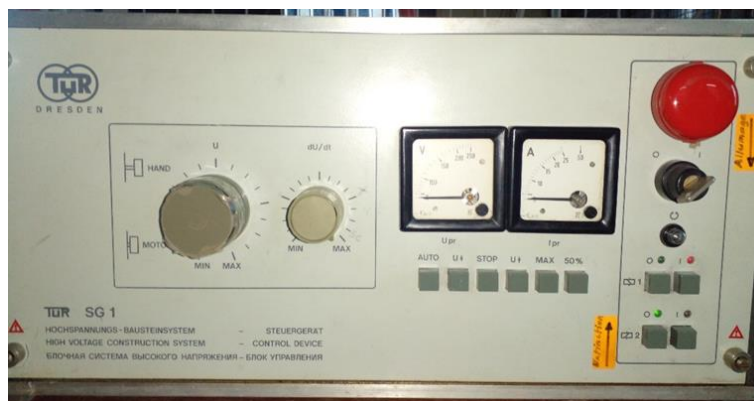
Figure III. 2: Appareil de Commande manuelle du transformateur (AC)
