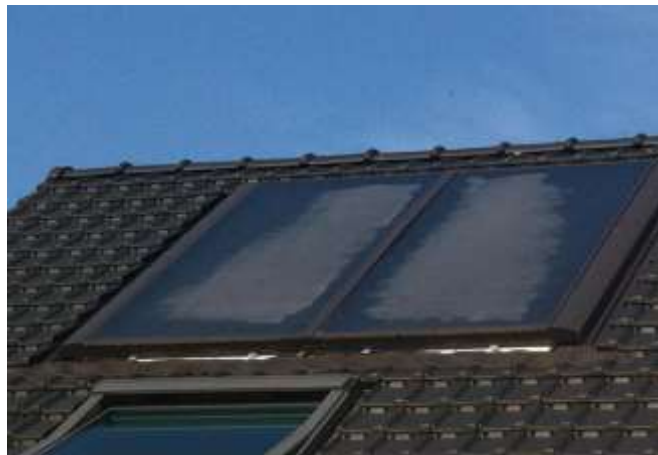
Figure (III-12) : Infiltration de l'humidité à l'intérieur des panneau PV.
