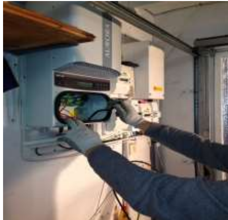
Figure (III-5) : Onduleur d'un panneau photovoltaïque.
