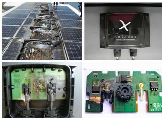
Figure (III-6) : Défaillance de boîte a jonction et endommageassions des panneaux PV.
