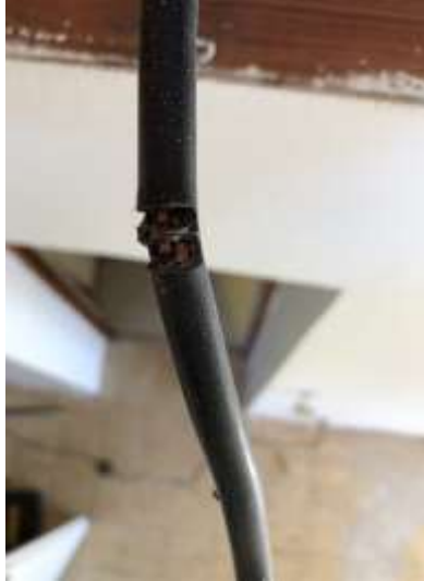
Figure (III-7) : Câbles endommagés.
