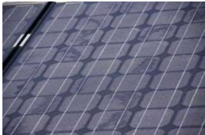
Figure (III-17) : Décoloration des panneaux PV.
