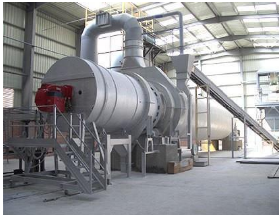
Figure. I.5. Four de cuisson du gypse [10]
