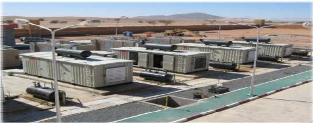
Centrales électriques réalisés dans le sud algérien
