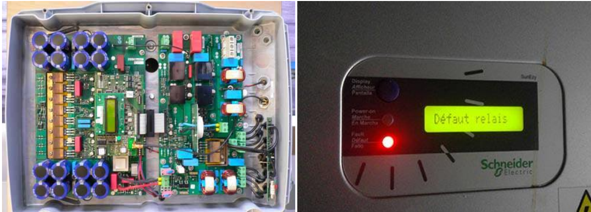
Figure II.3 : Problème d'onduleur photovoltaïque
