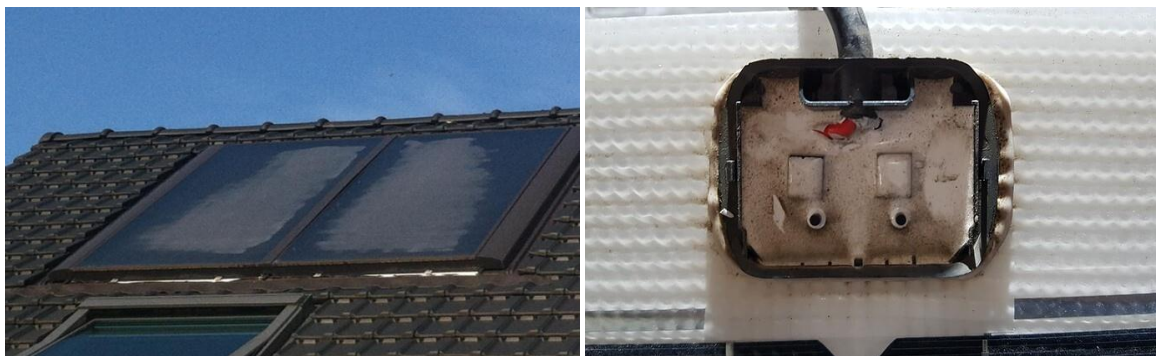
Figure II.6 : Pénétration de l'humidité
