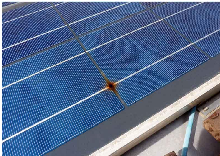
Figure II.2 : Mauvaise soudure des cellules photovoltaïques
