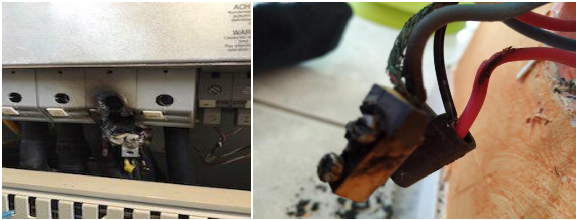
Figure II.5 : Défauts de câblage
