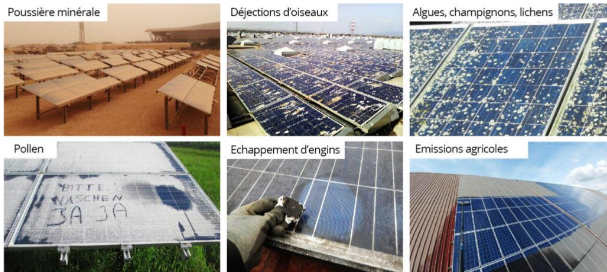
Figure II. 7 : Défaut de nettoyage des panneaux solaires
