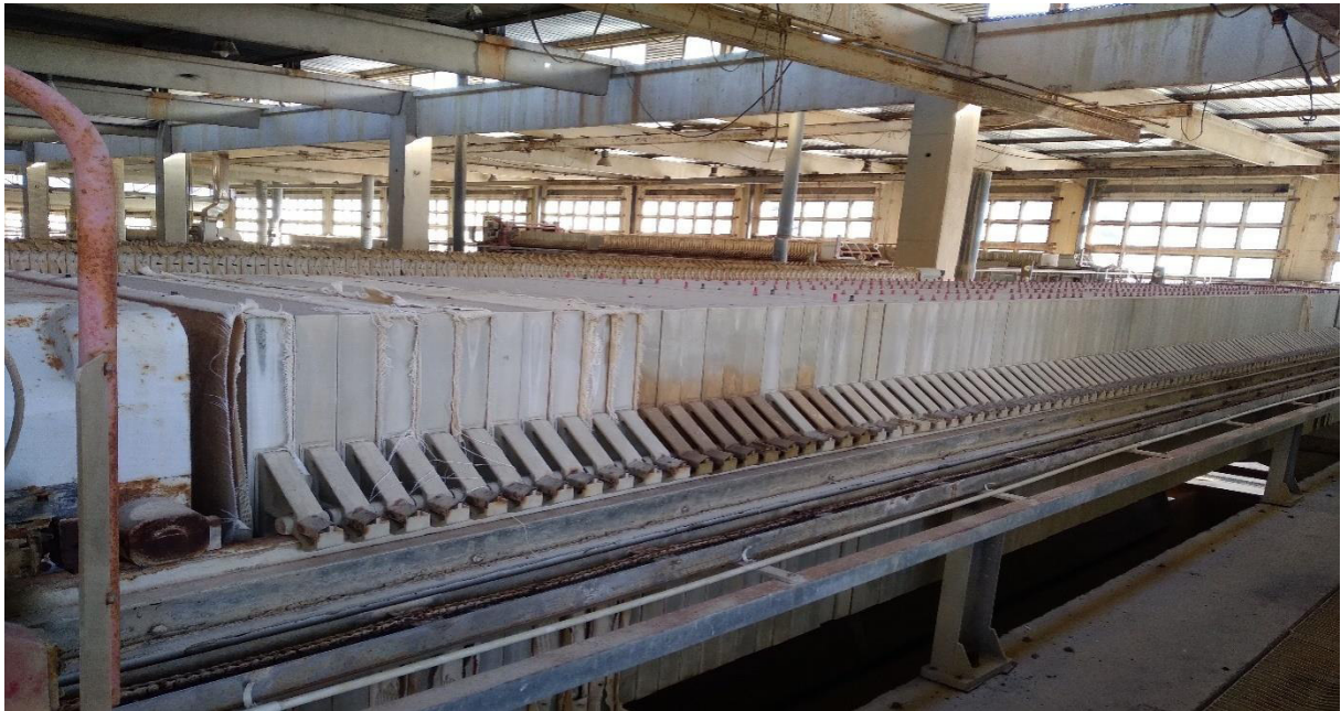
Figure 15: Filtre à presse
