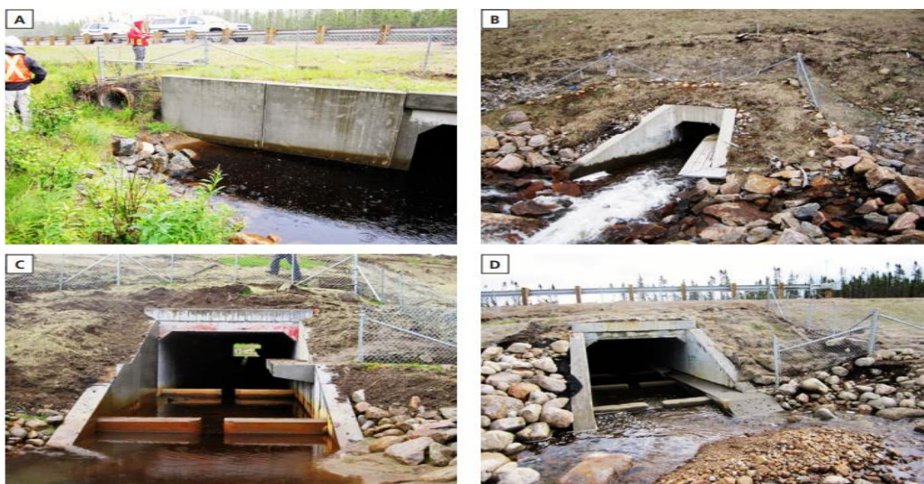
Figure 5 : Quatre types de passages fauniques conçus pour les mammifères de petite et de moyenne taille le long de la route : (a) ponceau sec (PS) ou tuyau circulaire, (b) ponceau avec tablette de bois installée en porte-à-faux (PTBois), (c) ponceau avec pied sec de type tablette de béton (PTBét); (d) ponceau avec banquette de béton (PBBét) ( Jochen A.G. Jaeger et al, 2019 ).
