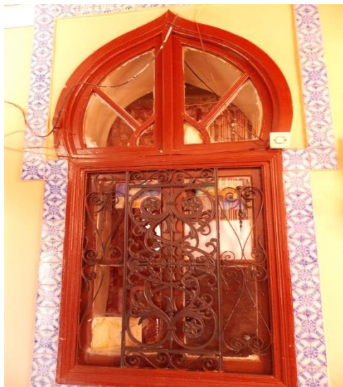
Figure 128 : montrant la forme des fenetres dans la maison Cheikh El Fegoun, source : auteurs, 2017
