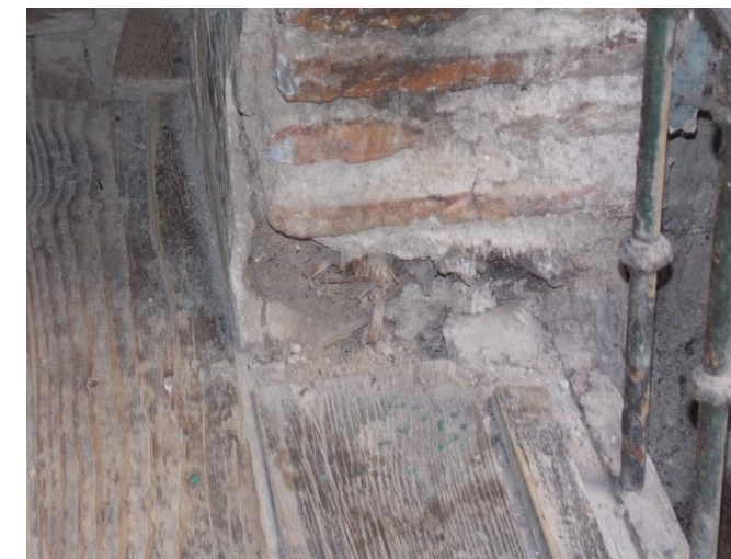
Figure 119 : montrant la dégradation des pilastres et le nouveau matériau utilisé pour les planchers de la galerie, source : auteurs, 2017
