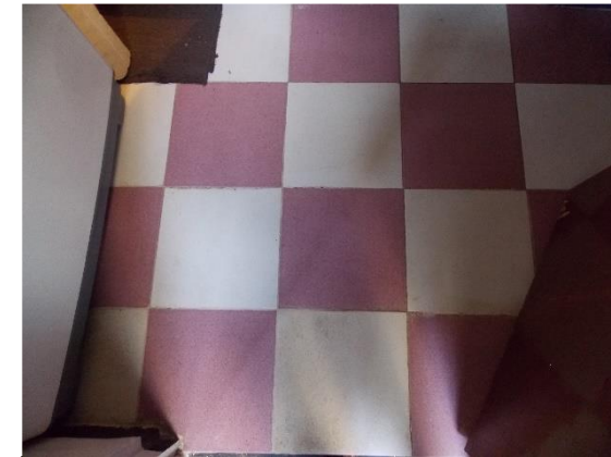
Figure 133 : montrant la dalle de sol utilisée dans certaines pièces, source : auteurs, 2017
