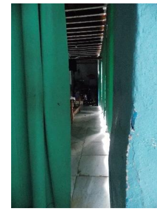
Figure 90 : montrant les rideaux des galeries. Source auteurs, 2017
