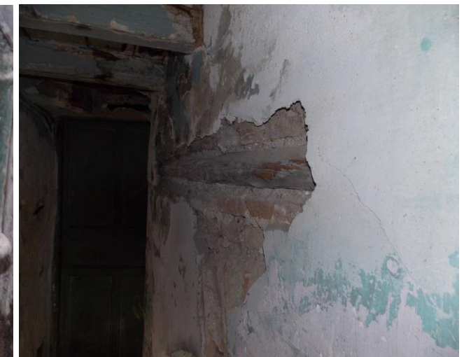
Figure 120 montrant la dégradation des murs porteurs et l'apparition des rondins en bois, source : auteurs, 2017
