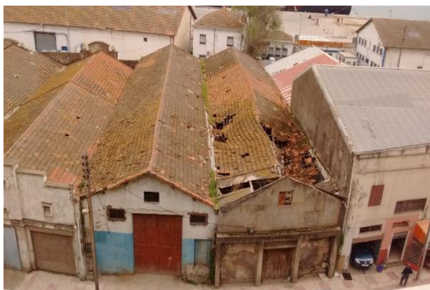
Figure 79 : l'état dégradé des hangars de l'arrière port. Source : auteurs 2017.
