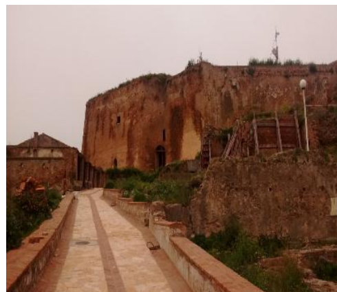
Figure 80 : état moyennement dégradé de la Casbah. Source : auteurs 2017.
