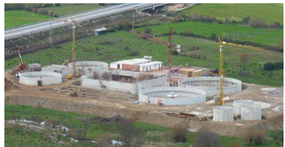
Photo27 :La station d'épuration de tamuda bay Source : Bureaux en France : Strasbourg, Metz, Lille, Paris, Aix-Marseille, Bordeaux,
