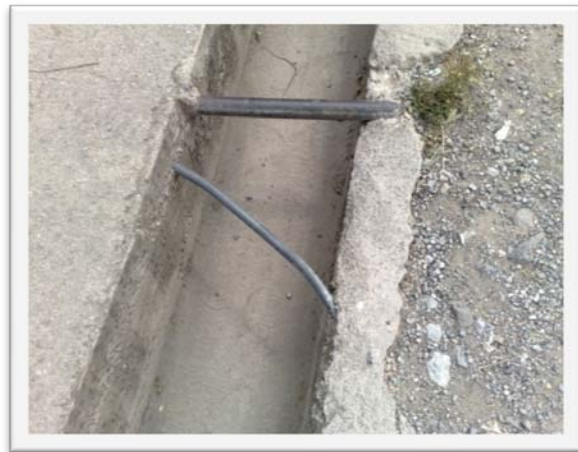
Photo N°43: Cette photo représente, une Conduite traversant un caniveau sans protection et plus la présence d'un câble électrique.
