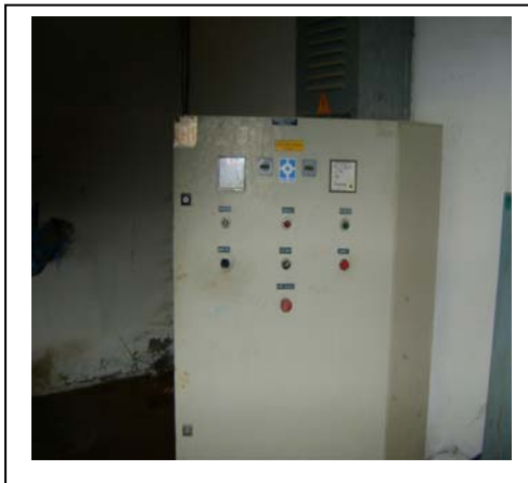
Photo N° 11 : L'armoire électrique de la station de pompage destinée vers la rive droite
