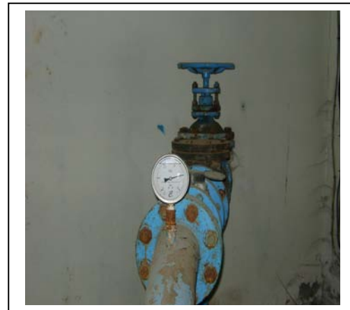
Photo N° 12 : La vanne de fermeture et le manomètre de pression
