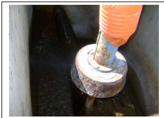
Photo N°26: La ventouse se trouve d'un état de dégradation très avancé.
