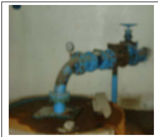
Photo N° 13 : Le puisard de la pompe immergée de la station de Douasla vers la rive droite
