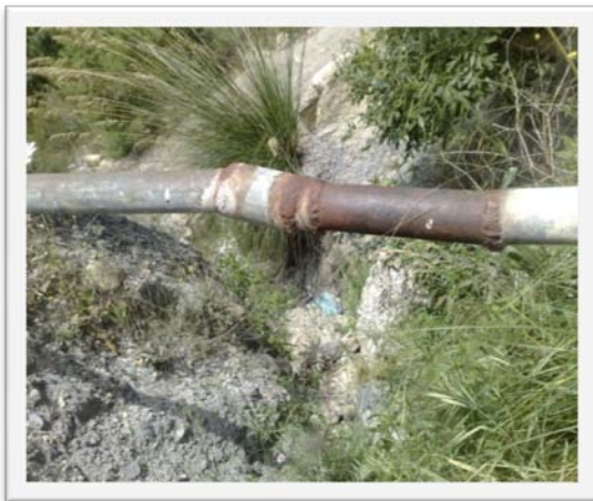
Photo N°42: Cette photo représente, une conduite déterrée soudé en plusieurs parties dans le réseau de Sidi Abderrahmane
