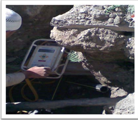
Photo N°34: Pendant la réalisation de réseau de gaz on a constaté plusieurs conduites qui sont détériorées par des engins.
