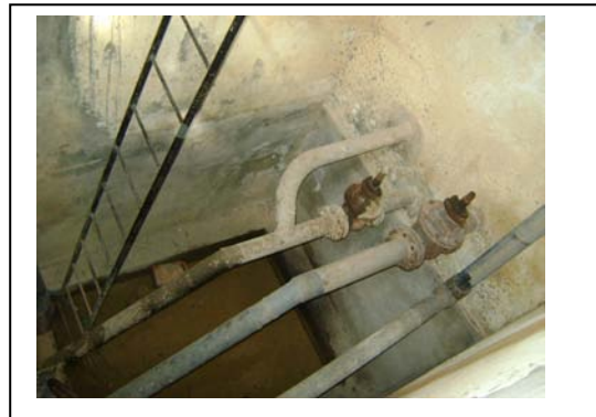
Photo N°23: Chambre vannes (Réservoir Sidi Abderrahmane)
