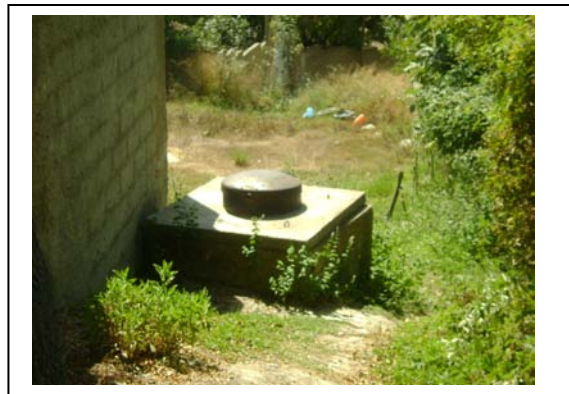
Photo N°27: Regard vanne pour la bifurcation vers les réservoirs de Sidi Abderrahmane.
