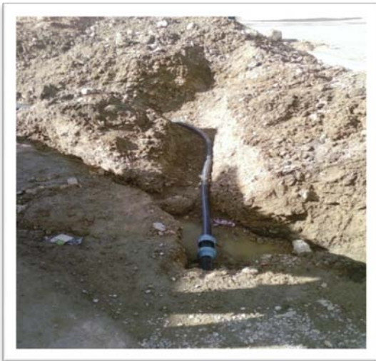
Photo N°36: Suite à des fuites permanentes sur l'ancienne conduite de nouveaux piquages sont réalisés.
