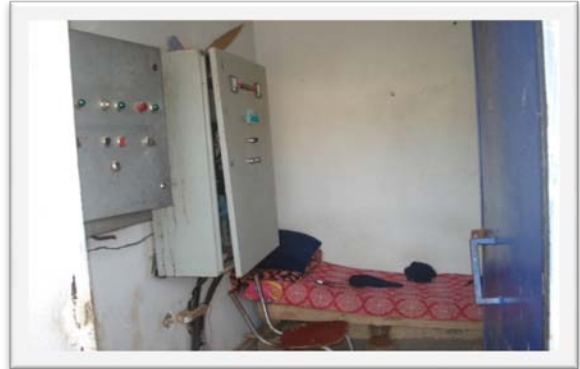
Photo N° 08 : L'une des armoires électriques est en panne
