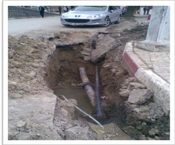
Photo N°37 : Cette photo représente l'état de vétusté de cette conduite en acier.
