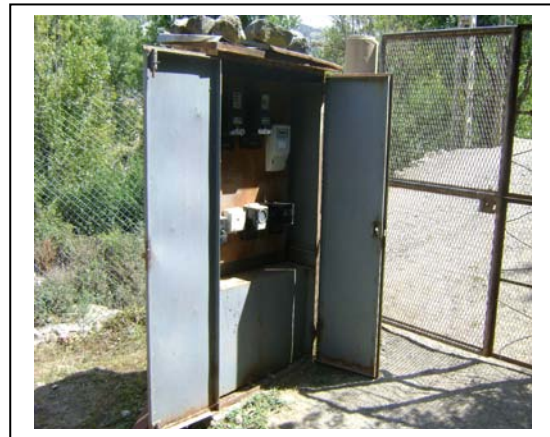
Photo N° 10 : Les compteurs électriques se trouvent à l'extérieur sans protection
