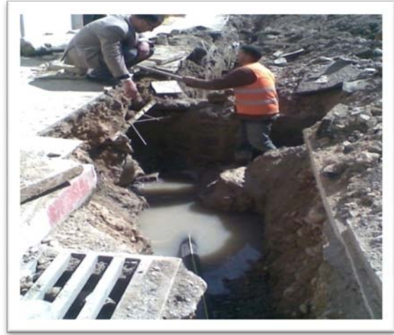
Photo N°35: Cette photo représente, les fuites importantes soit par le réseau d'AEP ou d'assainissement.
