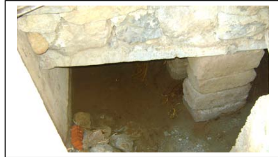
Photo N° 06 : Le fond de bassin n'est pas entretenu
