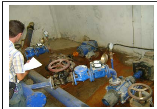
Photo N°22: Chambre électromécanique des réservoirs de Sidi Abderrahmane
