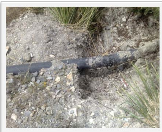
Photo N°31: Conduite déterrée (vers le réservoir du centre)
