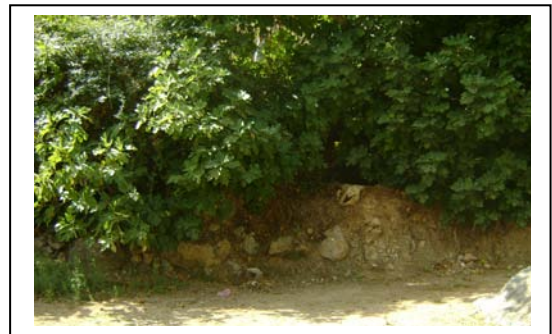
Photo N° 04 : Dégradation très avancée de la clôture, glissement et chute des pierres.
