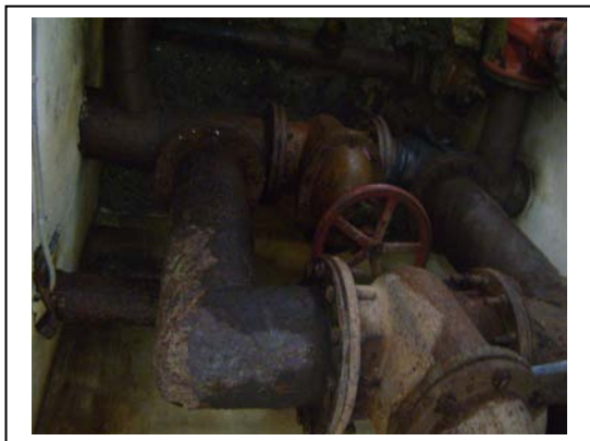
Photo N°19: Vue intérieure de la chambre de vannes du réservoir rectangulaire
