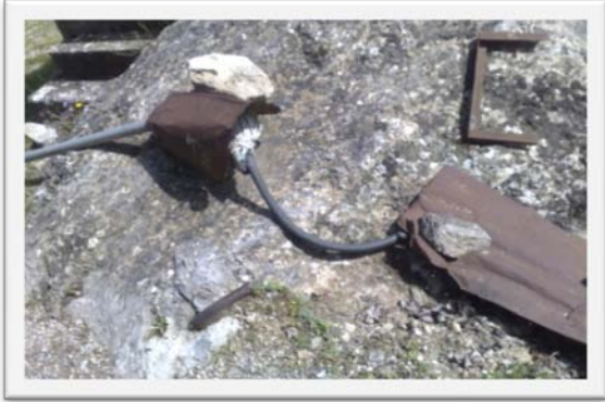
Photo N° 07 : état des câbles électriques
