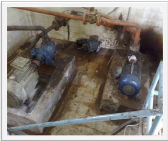
Photo N° 09 : Fuites à travers les joints et dégradation des vannes
