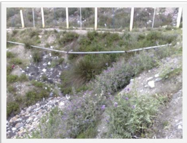
Photo N°30 : Conduite déformée suite au glissement des terrains
