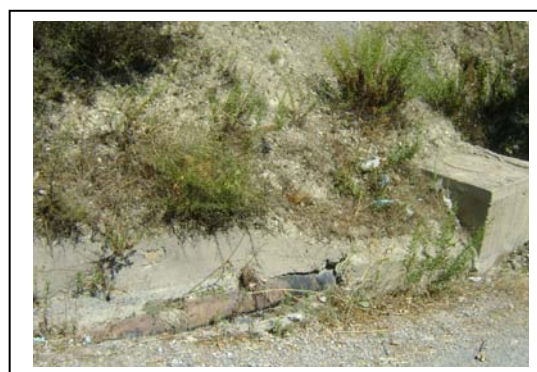
Photo N°29: Conduite d'adduction déterrée (vers Sidi Abderrahmane)
