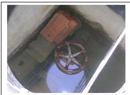
Photo N°28: Emergence totale en eau de la vanne de regard de bifurcation
