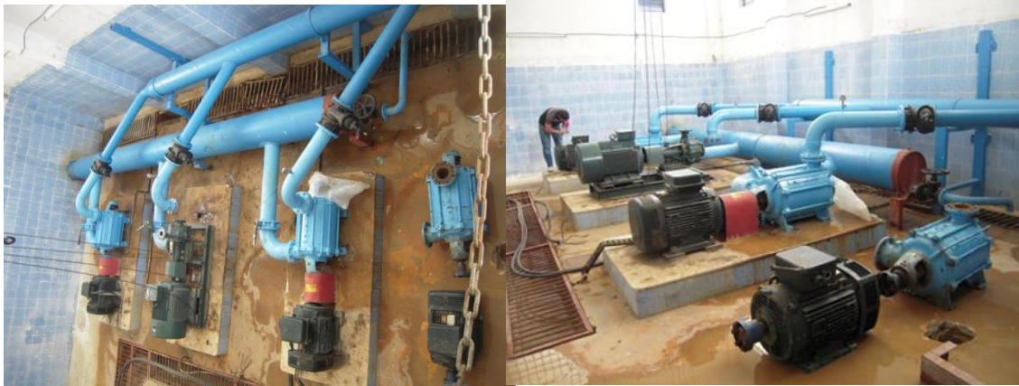
Figure III. 7. Vue de la station de pompage et ses équipements.
