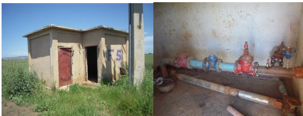
Figure III. 5. Vue du forage F5- Ses équipements et son abri
