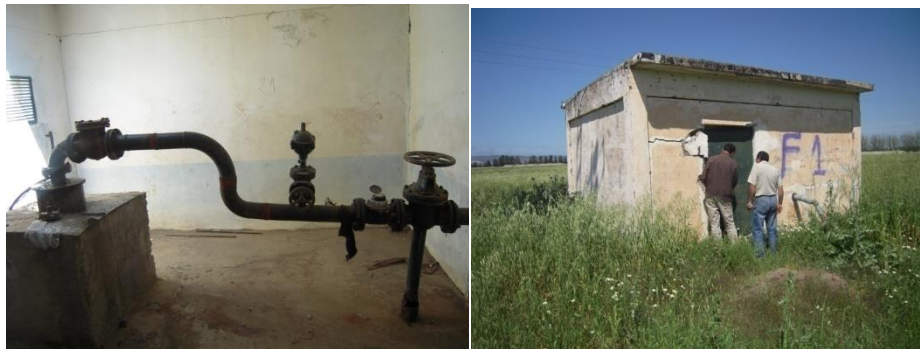
Figure III. 1. Vue du forage F1 HENNI- Ses équipements et son abri.
