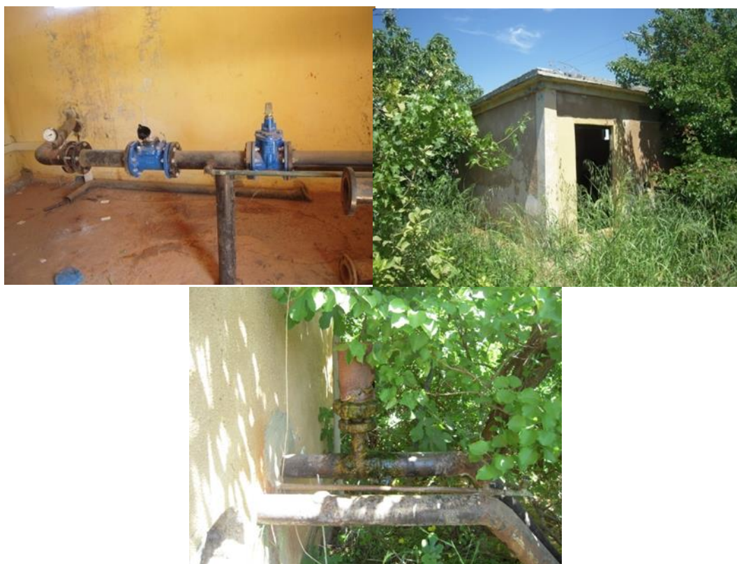
Figure III. 4. Vue du forage F4- Ses équipements et son abri
