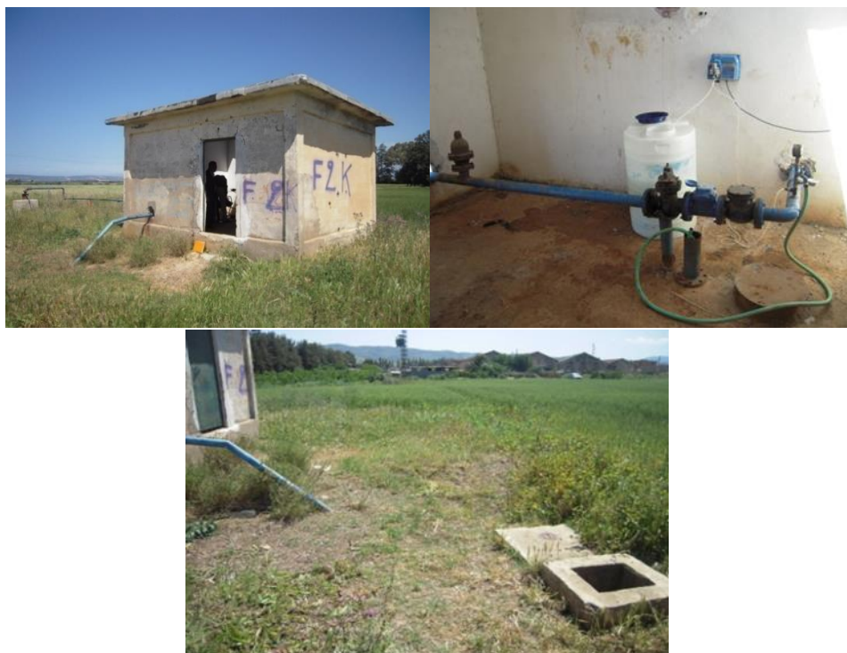
Figure III. 2. Vue du forage F2 KERFA- Ses équipements, son abri et sa vidange
