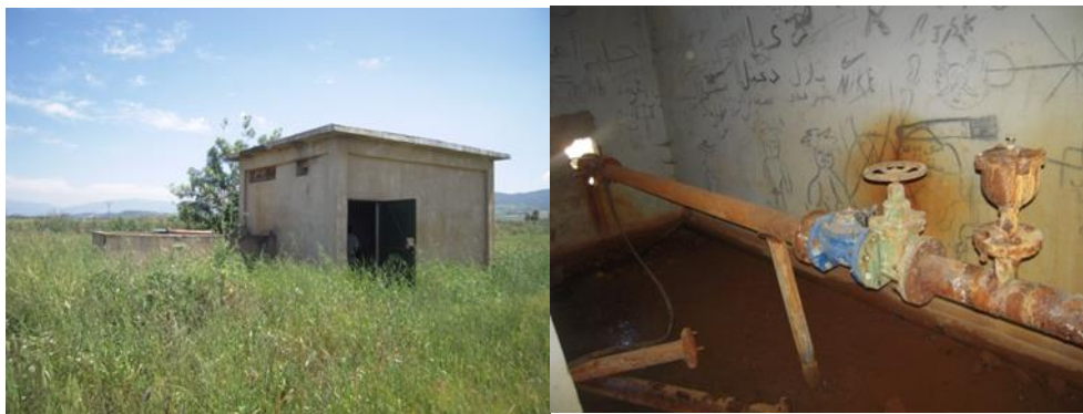
Figure III. 3. Vue du forage F3-Ses équipements et son abri
