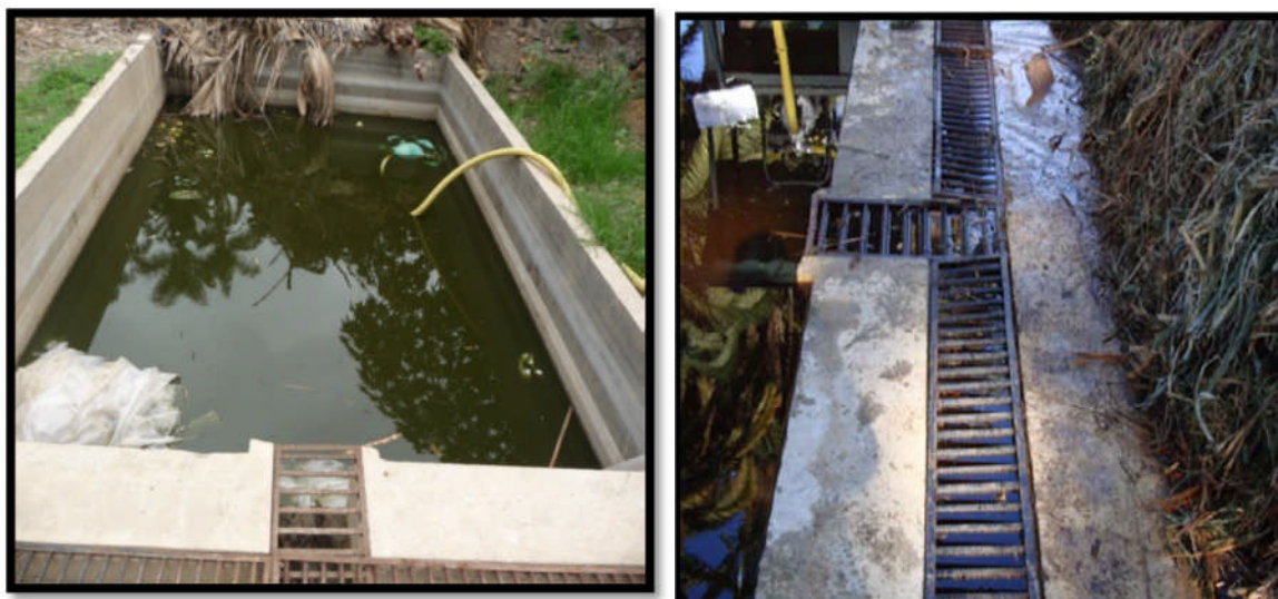
Figure 41 : Récupération de l'eau dans le bassin.
