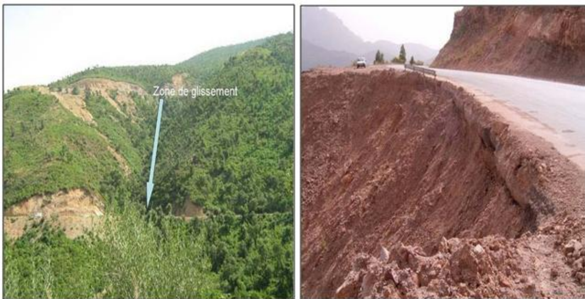
Figure 15 : Glissement coté aval de la RN 12[11]
