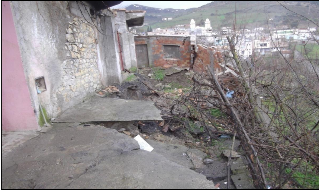
Figure 14: Effondrement de toute une maison [8]
