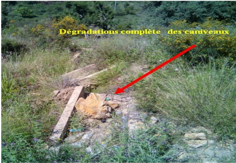
Figure 18 : Détérioration complète des caniveaux.
