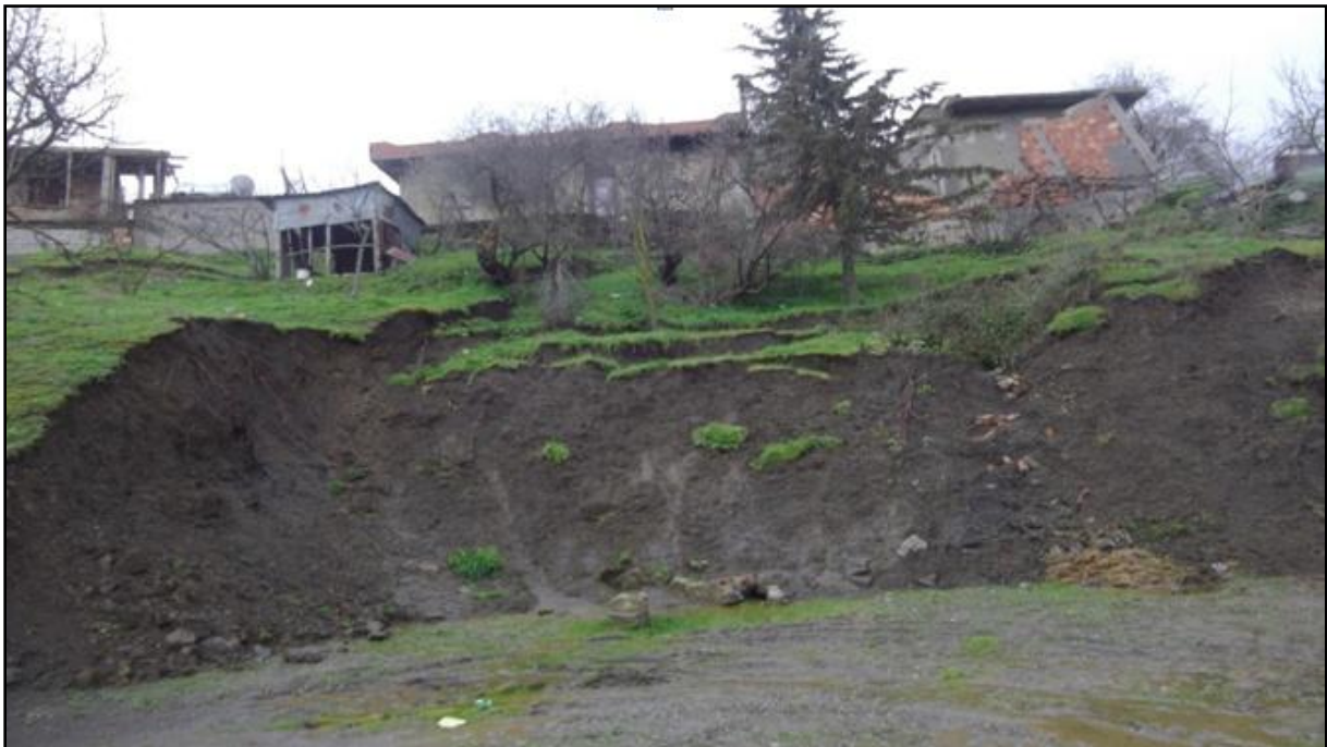
Figure 13 : Un talus cédé lors des terrassements [8]
