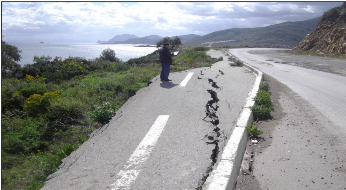
Figure 11 : Affaissement coté aval de la RN24 [8]
