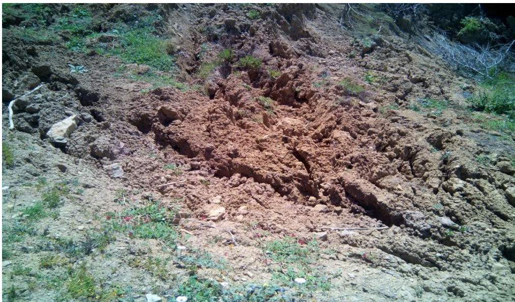
Figure 23 : Phénomène d'affaissement, de notre site étudié à Ouendadja commune Berbacha W Bejaia.
