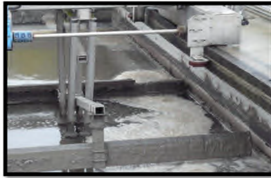
Figure IV.3: Dégraisseur/Déshuileur récolter de la station 20-04-2015.
