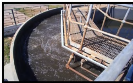
Figure IV.4: Bassin de traitement biologique récolter de la station 20-04-2015.
