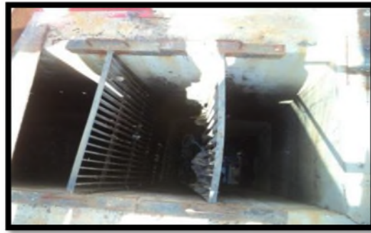
Figure IV.2: Dégrillage récolter de la station 20-04-2015.
