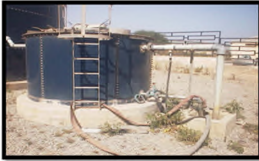
Figure IV.6: Bassin de désinfection.
