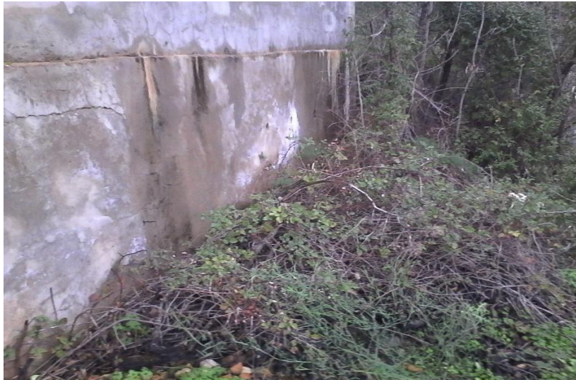
Figure V.3 : Création d'une ravine et rupture de mur de soutènement
