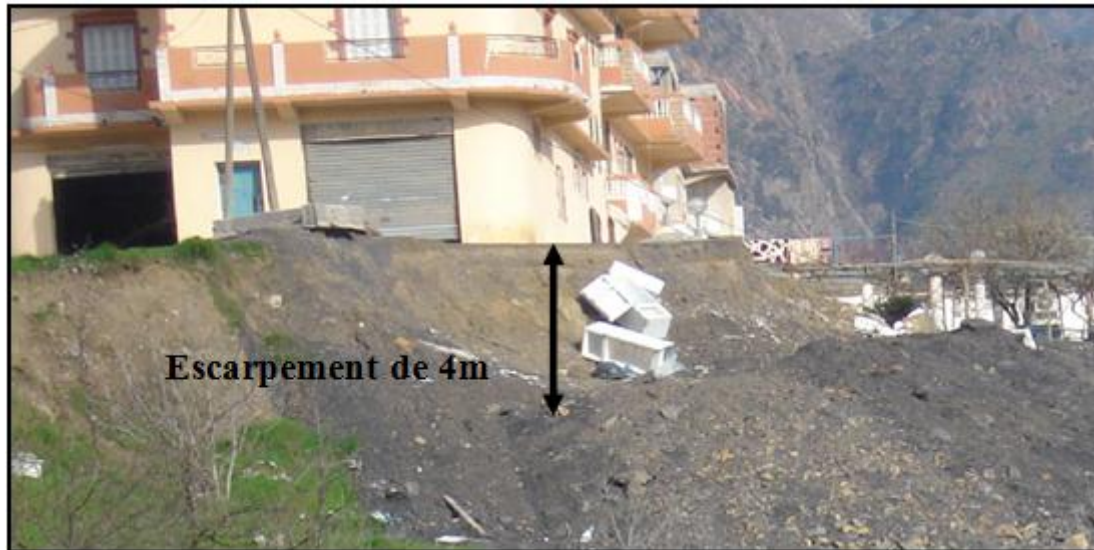
Figure II-4 : Escarpement du talus amont environ 4m.
