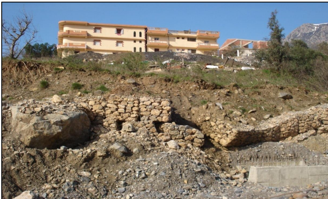
Figure II-7 : Renversement des gabions réalisés au niveau du bas du talus.
