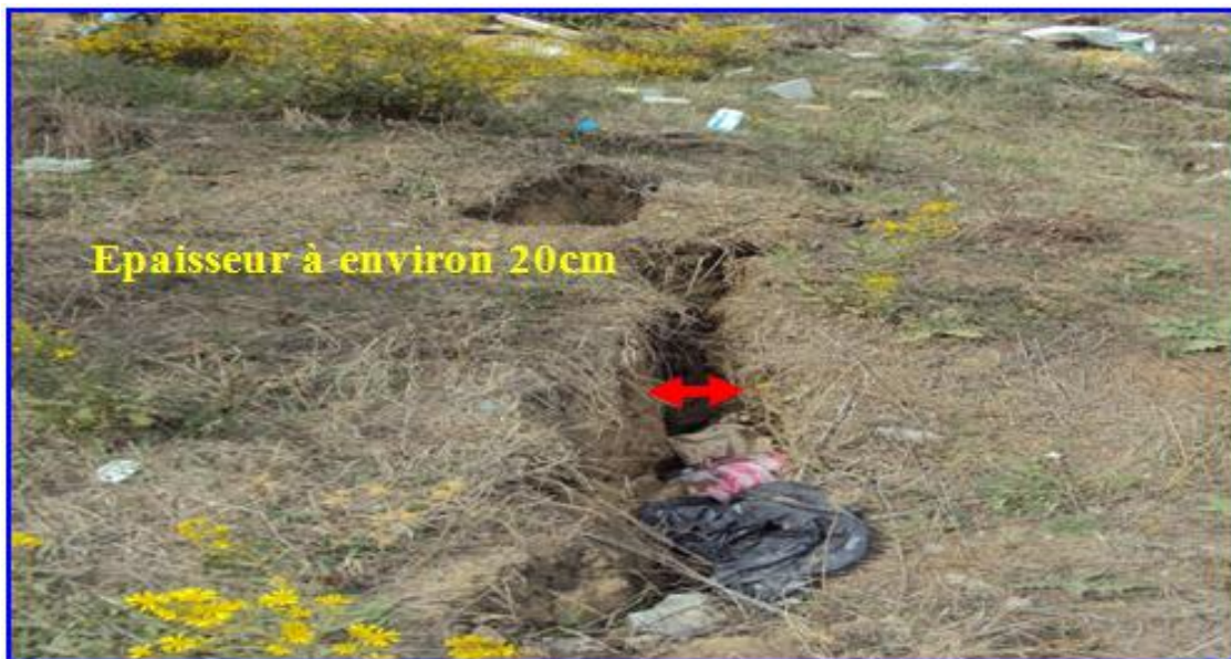
Figure II-5 : Des fissures de traction.
